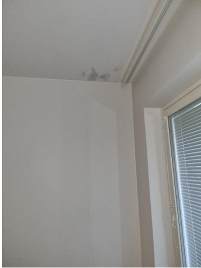
Kuva 19. Vuotokohta tupakeittiön katossa.
