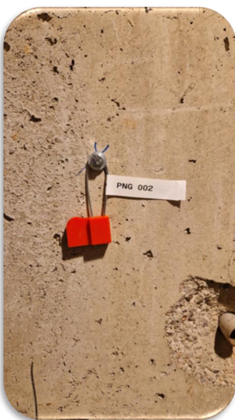
Kuva 6. Betoniseinään kiinnitetty passiivinen RFID-merkki (Kuva: Jyri Reijonen).
