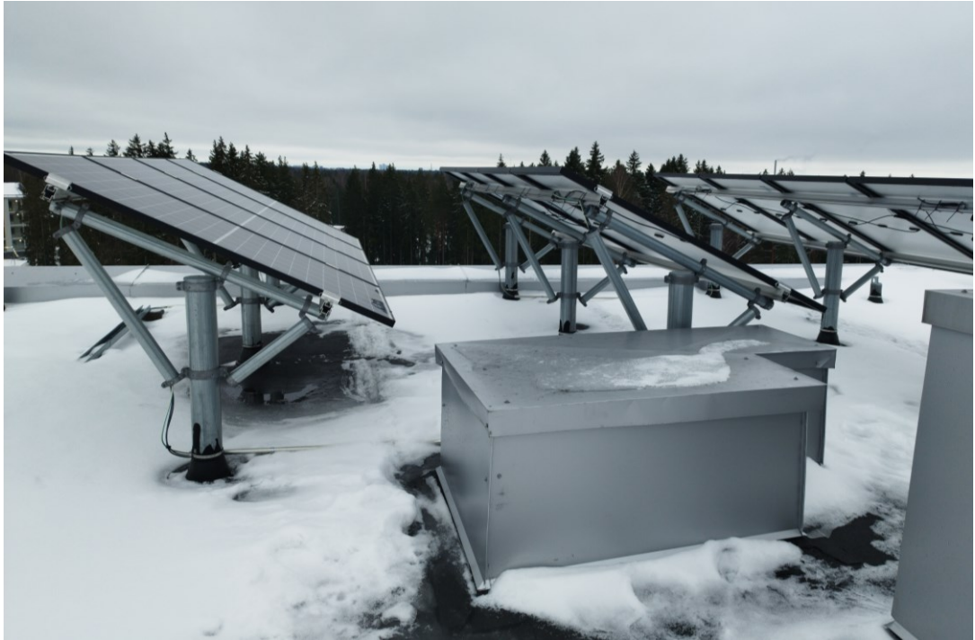
Kuva 4 Maisemamaalauksenkatu 1 aurinkopaneeliasennuksia (Paula Alanko)
