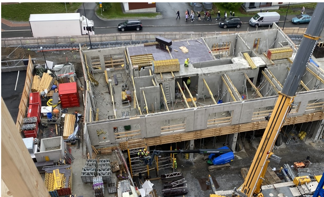
Kuva 3. Kerrostalon teräsbetonirungon ensimmäinen kerros. Kohteessa seinät tulivat valmiista teräsbetonielementeistä ja holvi rakennettiin paikalla valaen.
