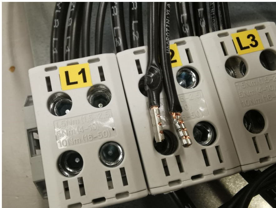
KUVA 8. Huolimattomasti tehty liitos, jossa eriste jäänyt liittimen väliin. (Rönkkö 2023)
