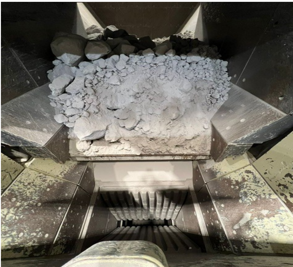
KUVA 13. Leukamurskain 11320 ja sen yläpuolella vaunusyötin 11300
