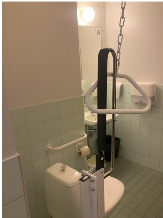
KUVA 24. Esteettömän wc-tilan tukijärjestelmät. (Kuva: Viivi Haasanen 2024).
