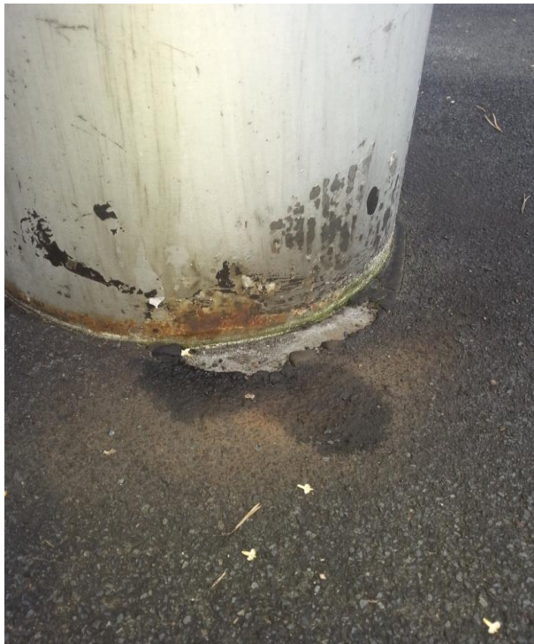
Kuva 1. Läpiviennin kohdalla on huopa vaurioitunut.
