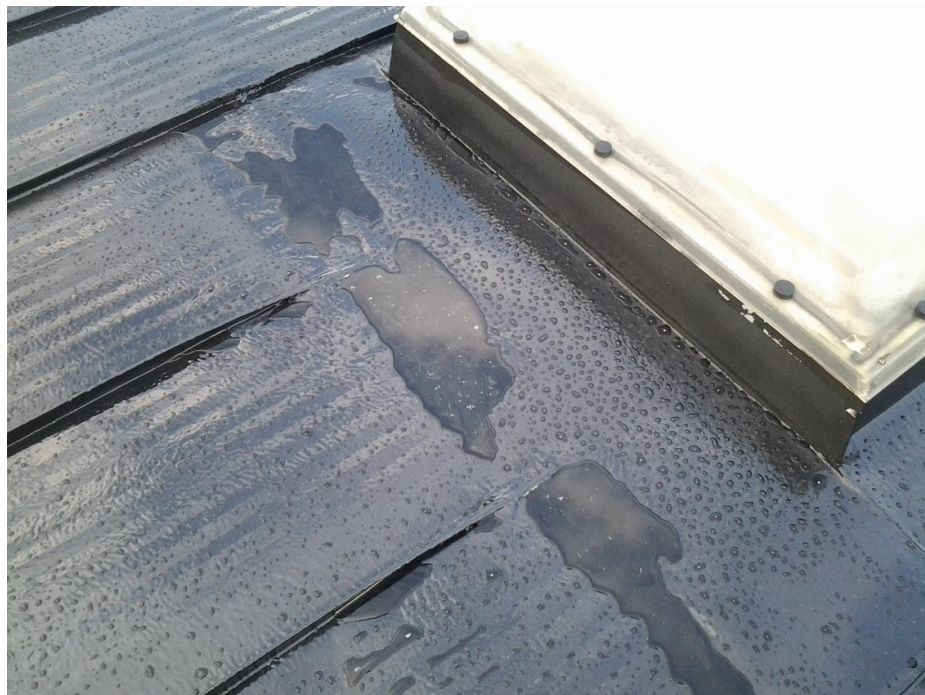
Kuva 12. Kuvassa olevien lätäköiden kohdalla on ollut vuotoa.
