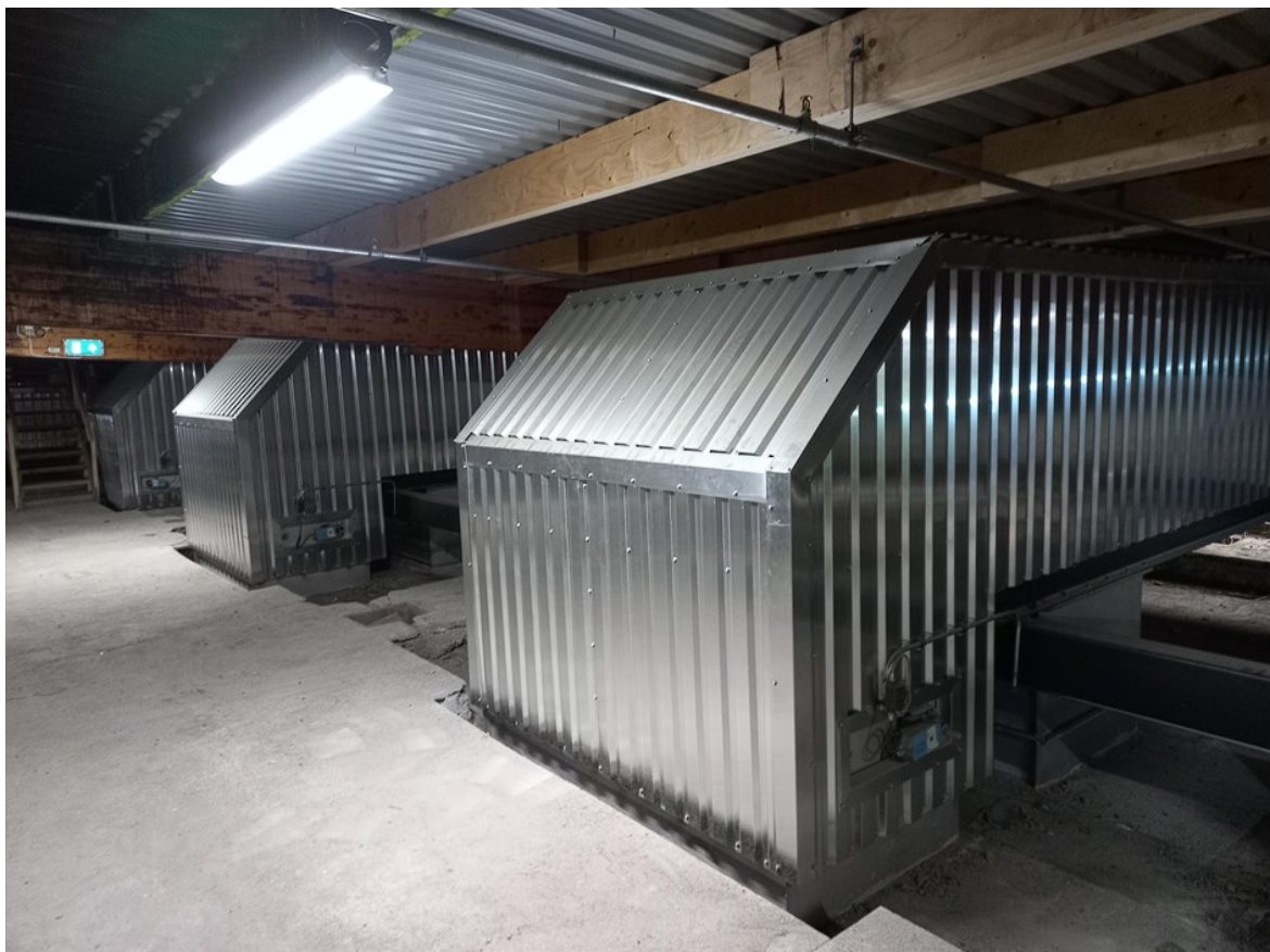
Kuva 5. Uusia lämmöntalteenotto yksiköjä vintillä. (Mustonen 2023.)
