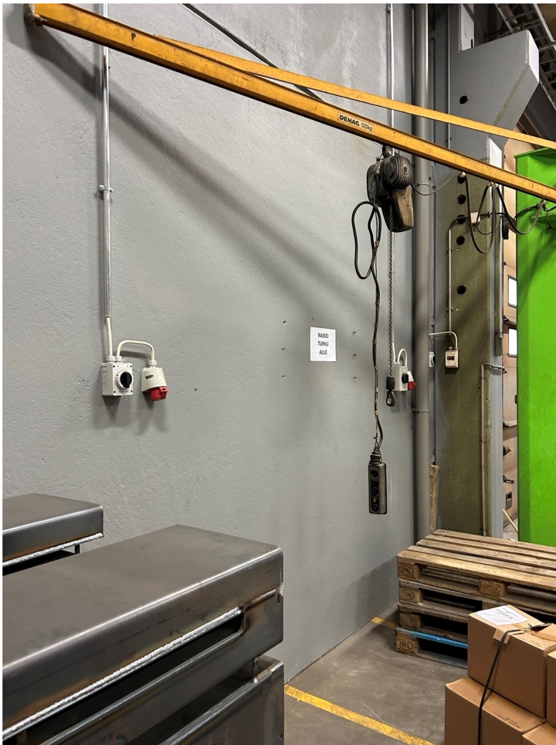
Kuva 17. Sähkösyötöt mankeli ja pitkäsauma (Markus Silvennoinen).
