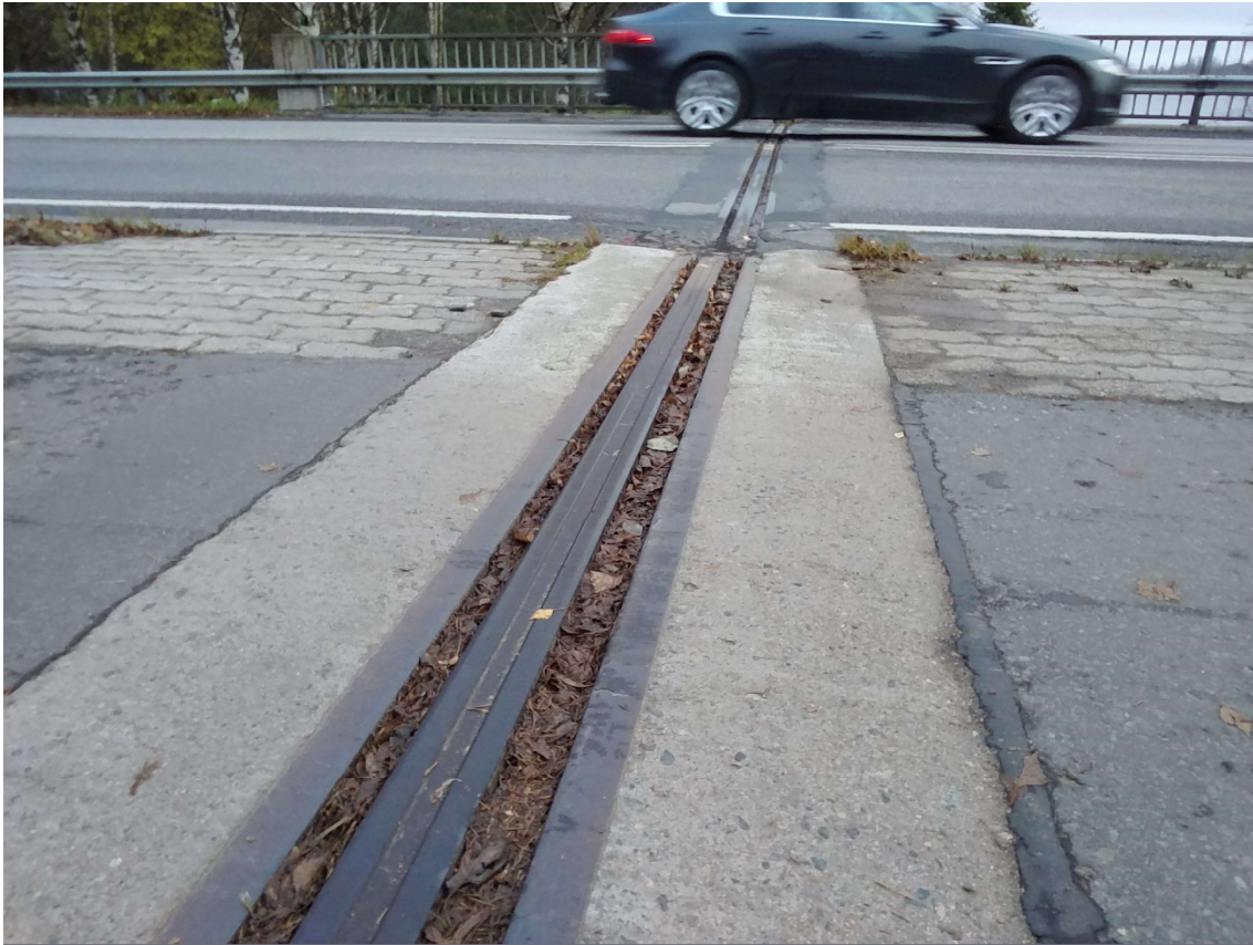
KUVA 9. Monikumisen liikuntasaumalaitteen vauriokuva, Erkkolan silta (5)
