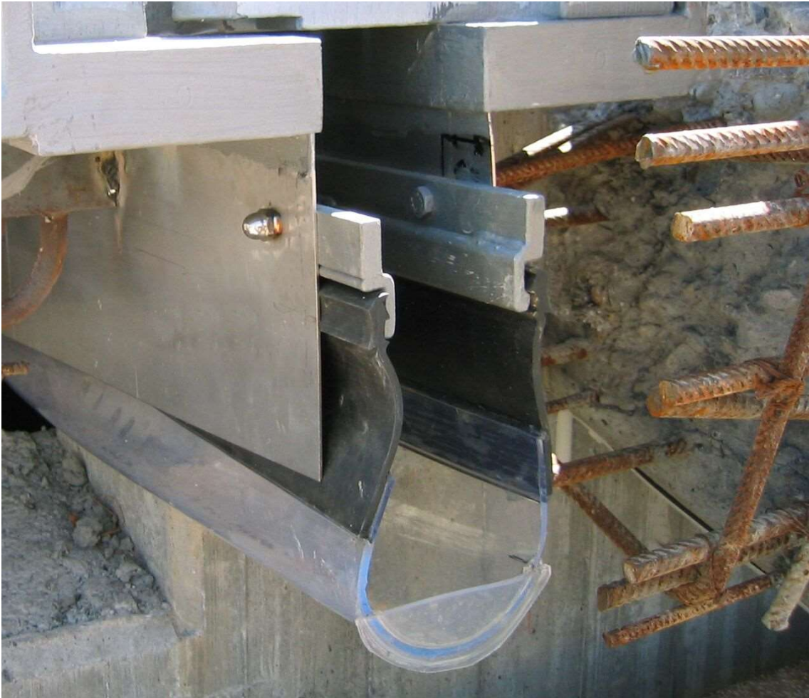
KUVA 12. Mageba TENSA-FINGER RSFD -sormiliikuntasaumalaitteen alapuolella oleva kouru hulevesille (14)
