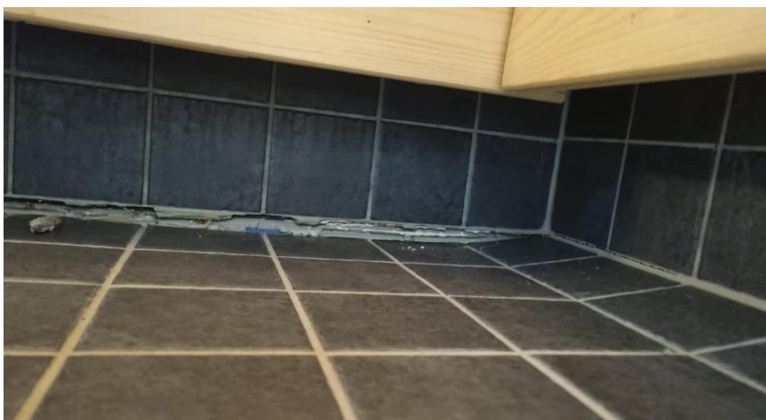
KUVA 9. Painunut lattia saunassa (Hartelan raportti 2021)
