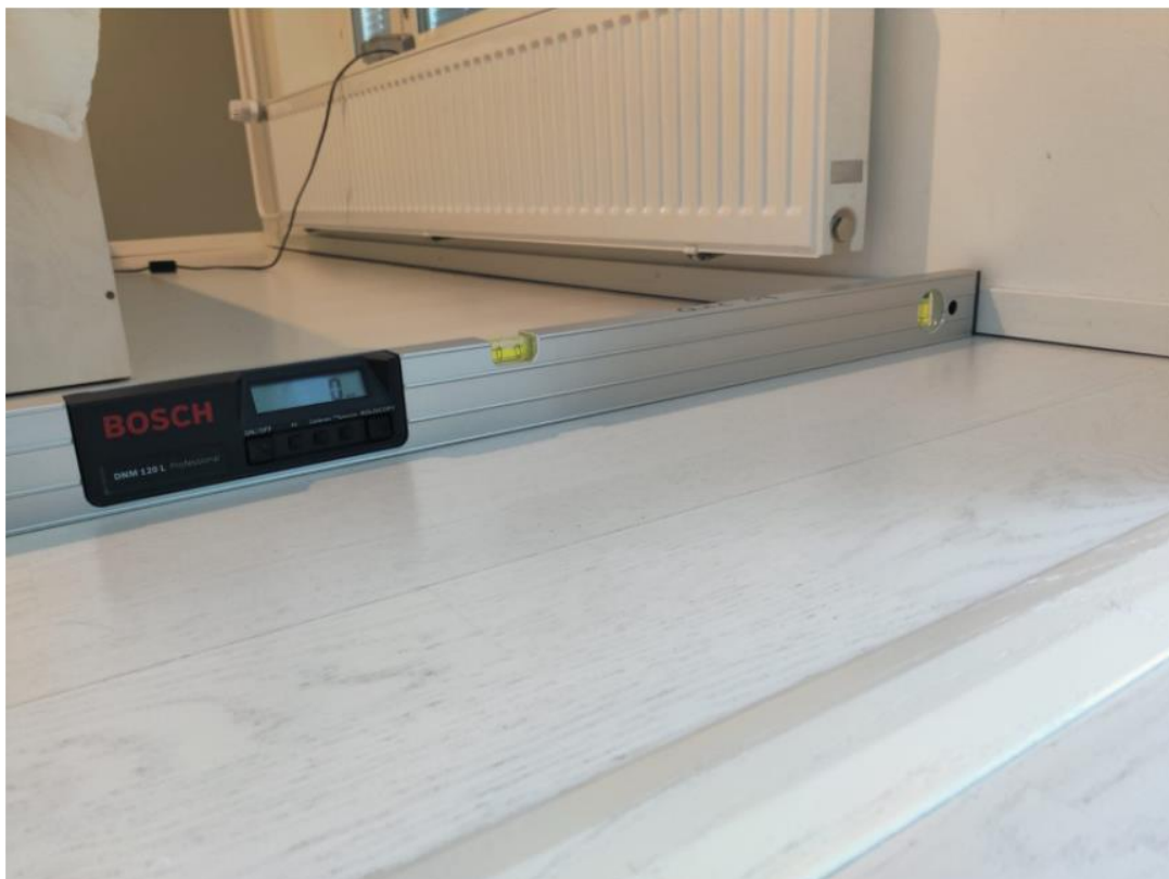
KUVA 12. Tilanne tarkasteluhetkellä makuuhuone 1. Lattia on suora mutta jalkalistat ovat n. 3 mm koholla. (Hartelan raportti 2021)
