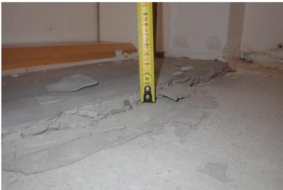
KUVA 8. Parvekkeen edustan parkettia on purettu alustan tarkastamista varten. Ulkoseinäelementin ja betonilaatan välillä oli noin 10 mm korkoero. Kynnyksen edustalle on rakentamisen aikana tehty laastiviiste. Laastiviiste oli murtunut. (Hartelan raportti 2021)
