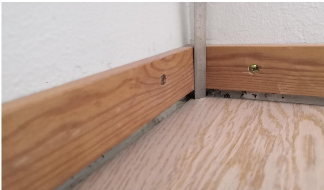
KUVA 5. Ulkoseinälinjalla parketin ja jalkalistan välissä noin 5 - 8 mm rako. (Hartelan raportti 2021)
