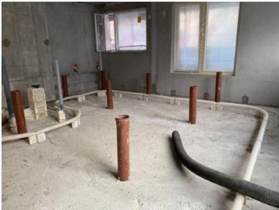
KUVA 20. Pilari putket (Hartela 2024)
