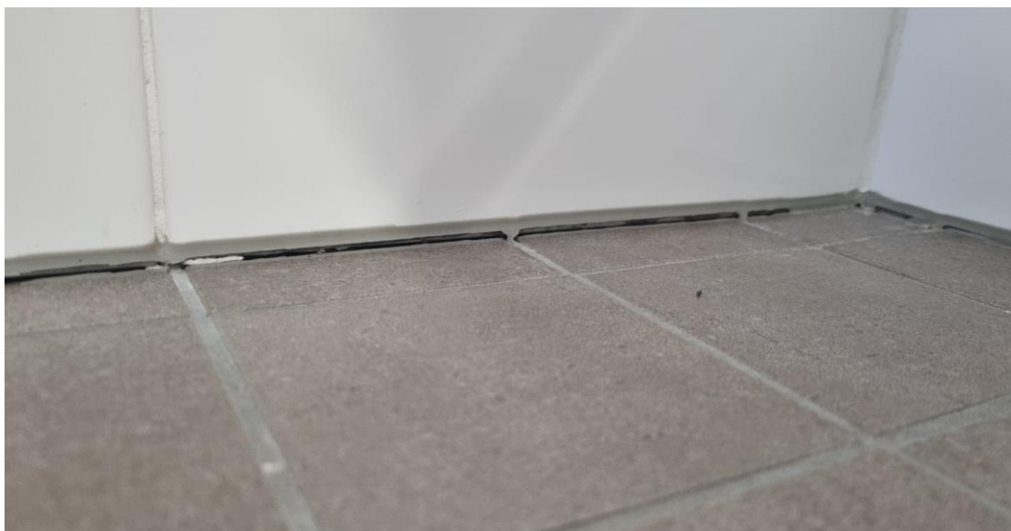
KUVA 2. Irronnut silikoni pesulan lattian ja seinän liitoksessa (Hartelan raportti 2023)
