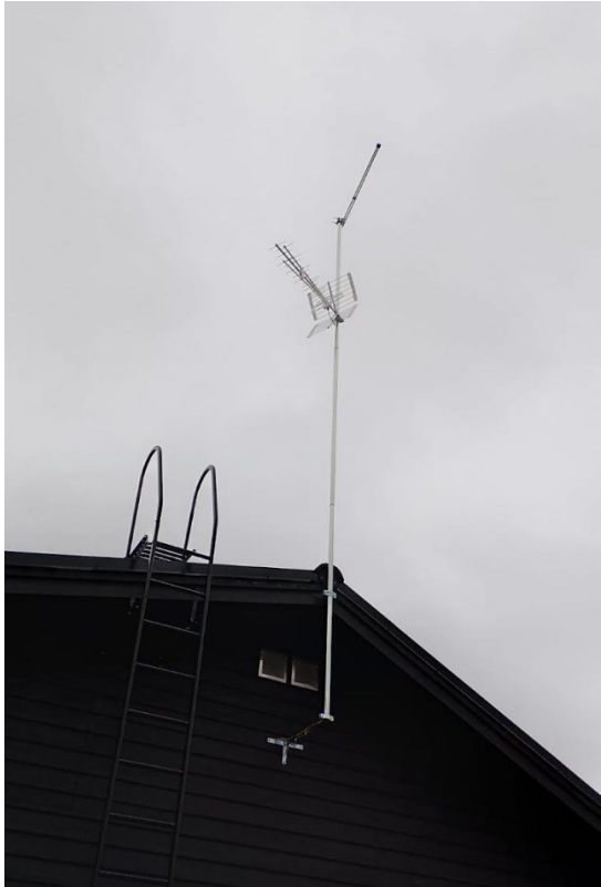
Kuva 11. GSM suunta-antenni mastoputkessa (Kuva: Eetu Löppönen 2024).
