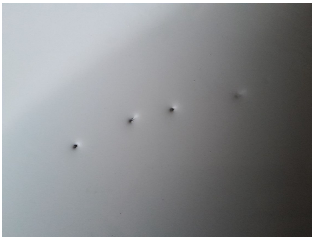
Kuva 7. Valmiissa PU-lattiapinnassa olevia reikiä, jotka ovat saattaneet aiheutua huokoiseksi jääneestä pohjustuskäsittelystä.
