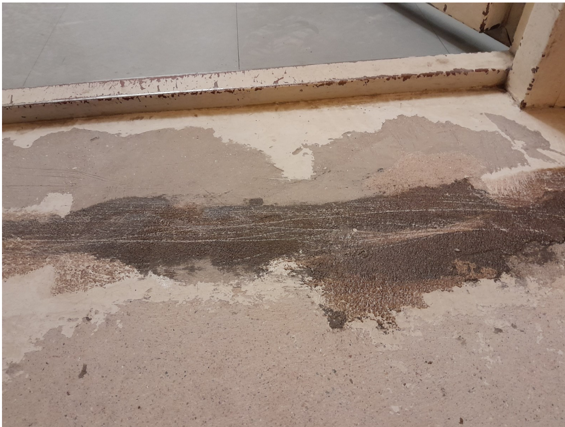
Kuva 6. Tiivistysepoksipohjusteen ja luonnonhiekan seoksella paikattu betoni-lattiapinnan vauriokohta.
