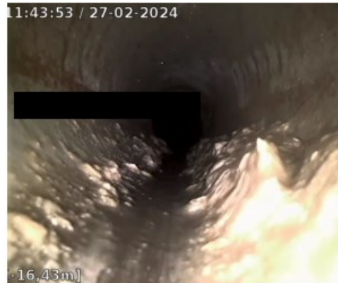
Irtosaostumaa viemärin pohjalla
