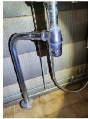
Kylpyhuoneen messinkinen vesilukko
