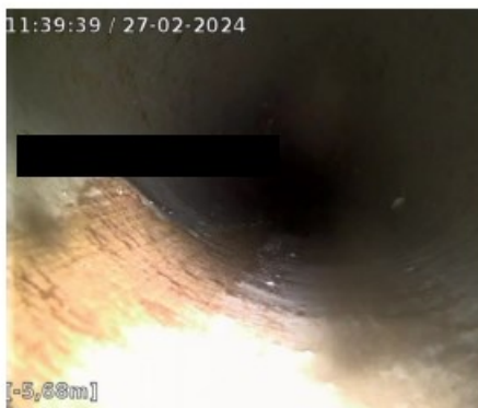
Paineen aiheuttama muodonmuutos klo.08:00
