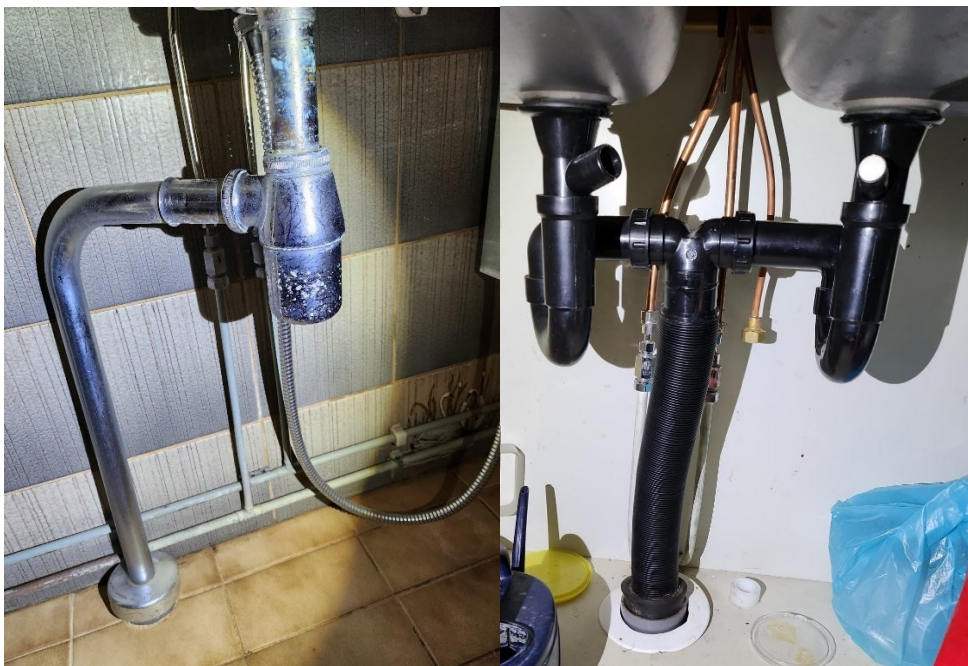
Kuva 4. Kylpyhuoneen ja keittiön vanhat vesilukot. (Kuva: Henri Kaipainen.)
