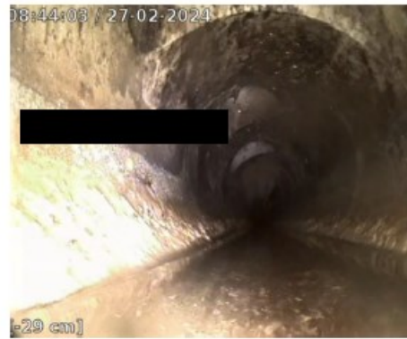
Viemärissä huono kaato
