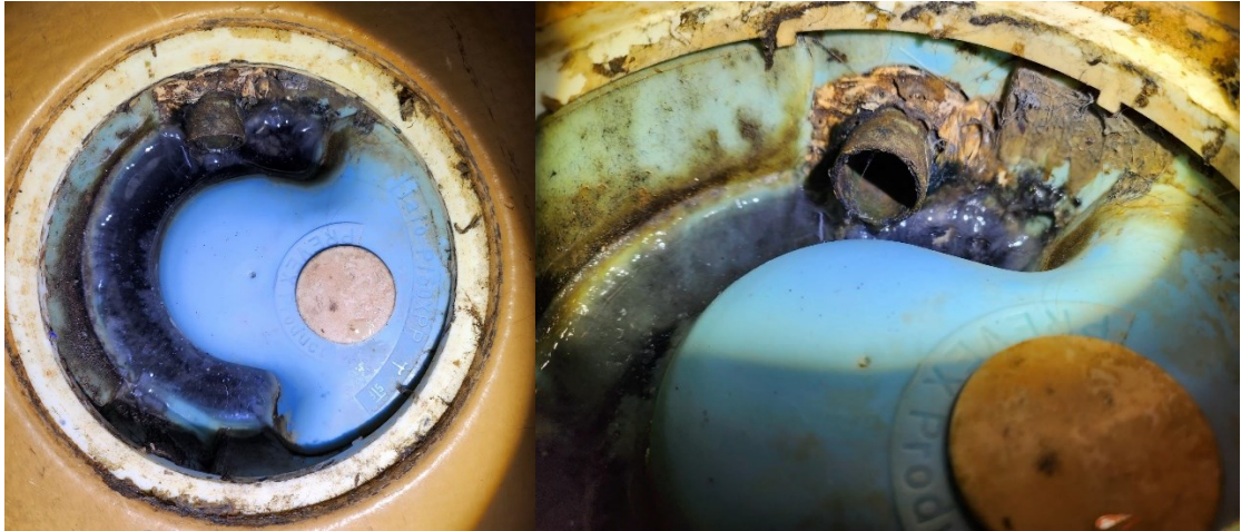
Kuva 3. Vanha lattiakaivo ja pyykinpesukoneen kupariviemäri. (Kuva: Henri Kaipainen.)
