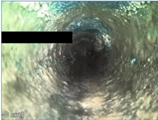
Korroosiota pesualtaan kupariviemäriässä
