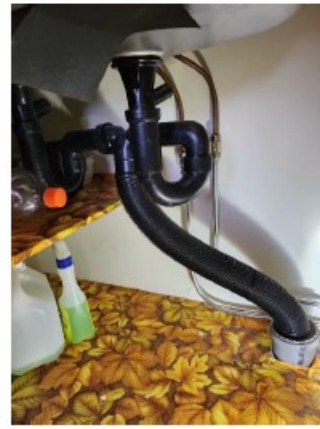
Alkuperäinen keittiön vesilukko
