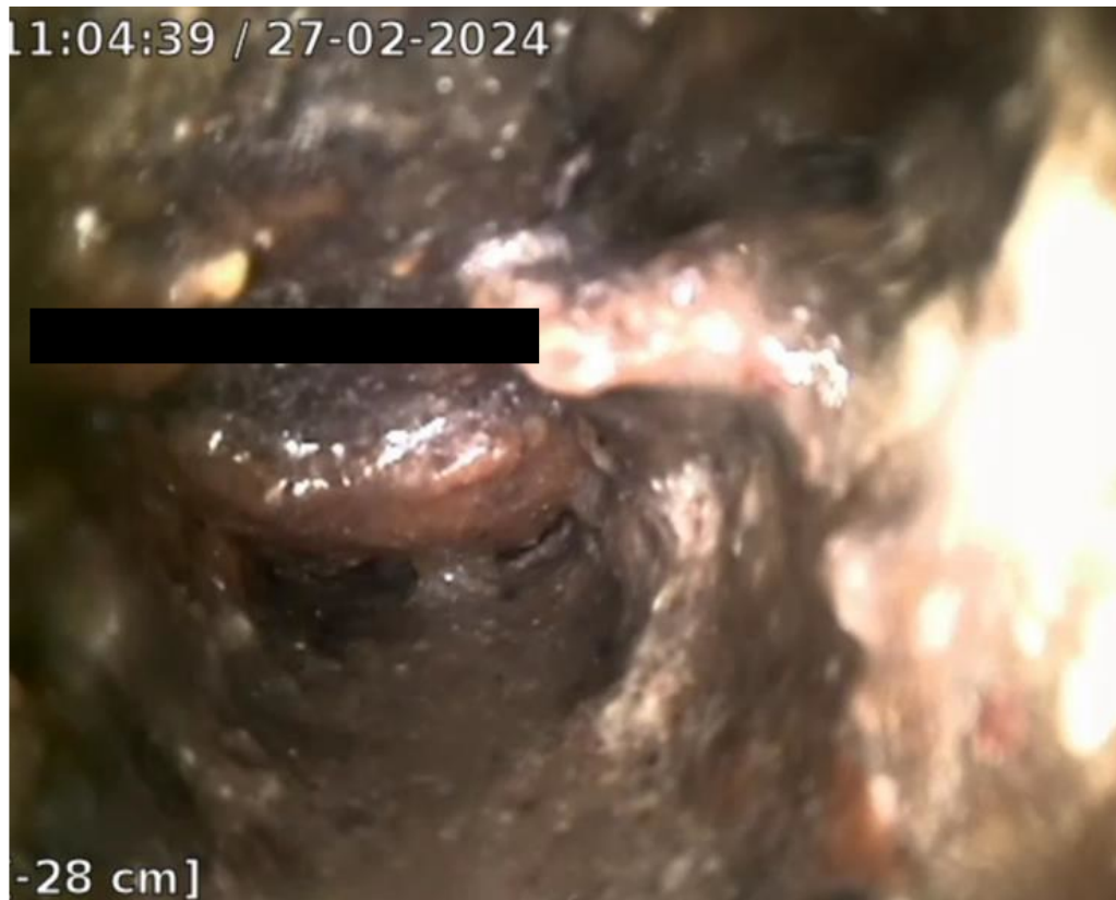
Kuva 12. Runsaasti rasvaa keittiön viemärissä. (Kuva: Henri Kaipainen.)
