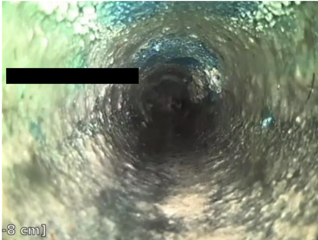
Kuva 9. Korroosiota kuparisessa pesualtaan viemärissä. (Kuva: Henri Kaipainen.)
