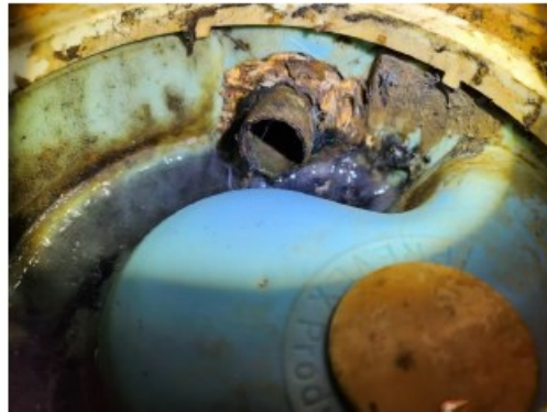
Pyykinpesukoneen kuparisen viemärin liitos
