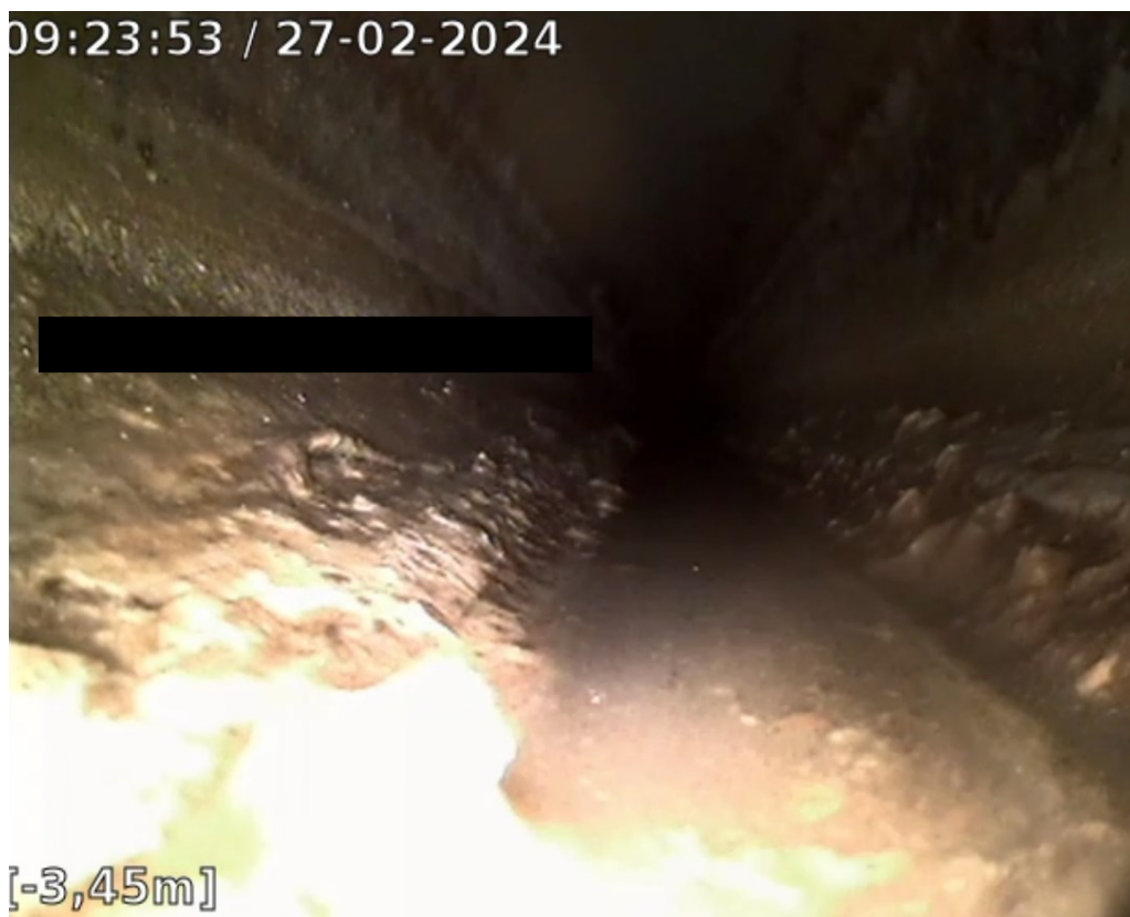
Kuva 13. Kiinteää saostumaa putken pohjalla. (Kuva: Henri Kaipainen.)
