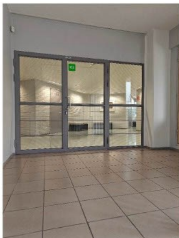
Kuva 52. Sisäpihan oven vieressä olevan porraskäytävän toisen kerroksen sisäovi. Kynnys käytävältä porraskäytävään tultaessa on suositeltua korkeampi ollen 25 mm (suositus <20 mm).
