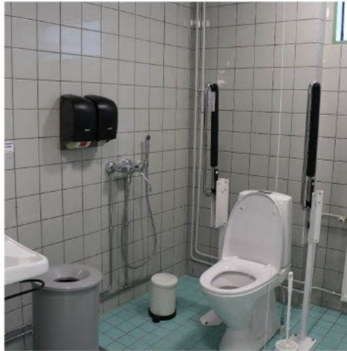
Kuva 27. Esteettömässä wc-tilassa on molemmin puolin wc-pyttyä vapaata tilaa. Käsisuihku on hieman liian etäällä wc-pytystä. Hälytysnaru roikkuu ka- tosta wc-pytyn lähellä ja ulottuu lähes lattiapintaan asti.
