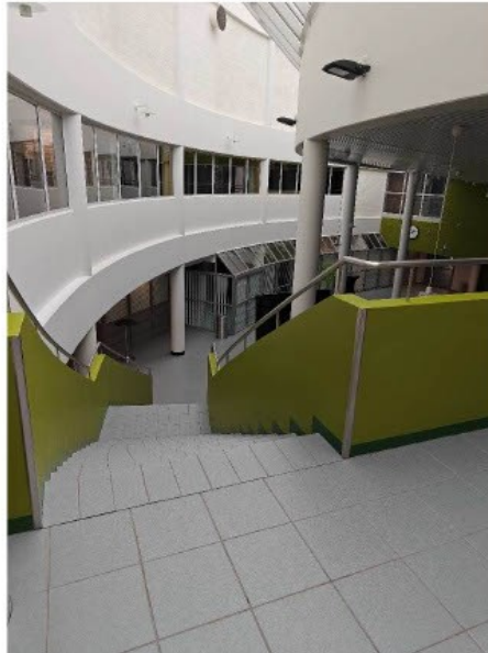
Kuva 46. Kuva portaiden yläpäästä. Kaide ei jatku portaita pidemmälle. Portaista varoittavaa merkintää ei ole lattiassa.
