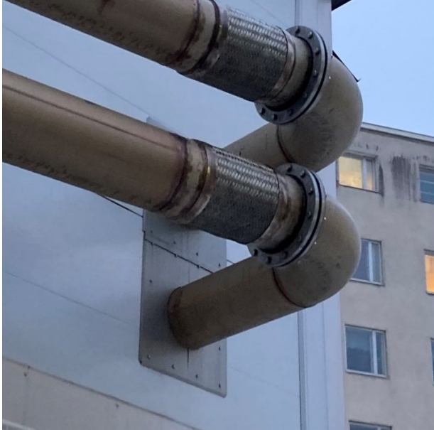
Kuva 6. Tyks:n varavoimakoneiden pakoputken läpivienti.
