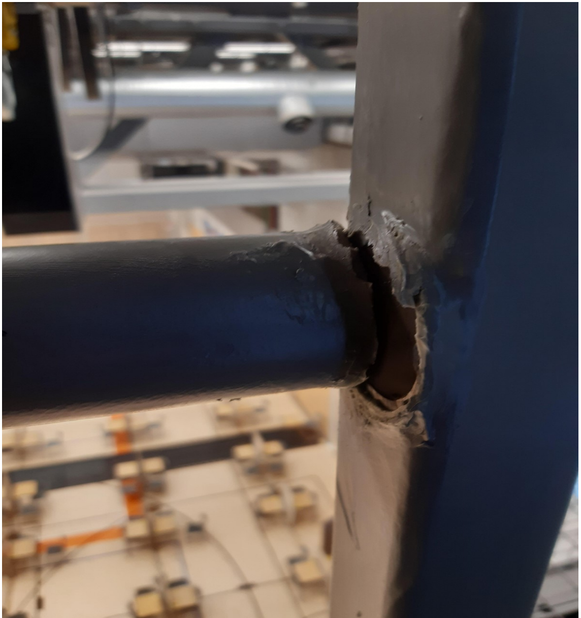
Kuva 4 Monitoimikeskus Lumon liikuntahallin murtunut kaiderakenne (Koski-vaara 2021)
