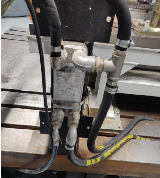
KUVA 25. TC1:n polttoaineen jäähdytyksen lämmönvaihdin
