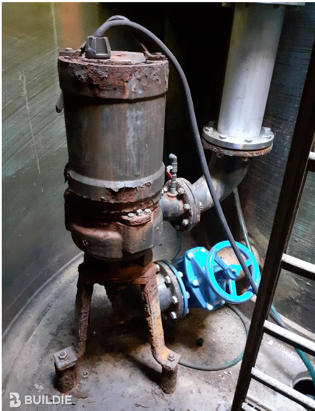
Kuva 13: 33 vuotta vanha pumppu. Vaikka pumpussa on runsaasti ruostetta, se toimii ja ajaa tehtävänsä. Tällaisissa kohteissa on kuitenkin tarpeen suorittaa tarkistuskierroksia riittävän usein.
