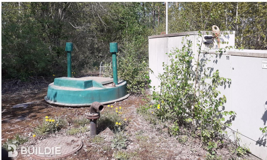
Kuva 15: Sähkökaapin oven edessä kasvaa koivun alkuja, jotka estävät kaapin oven avaamisen.
