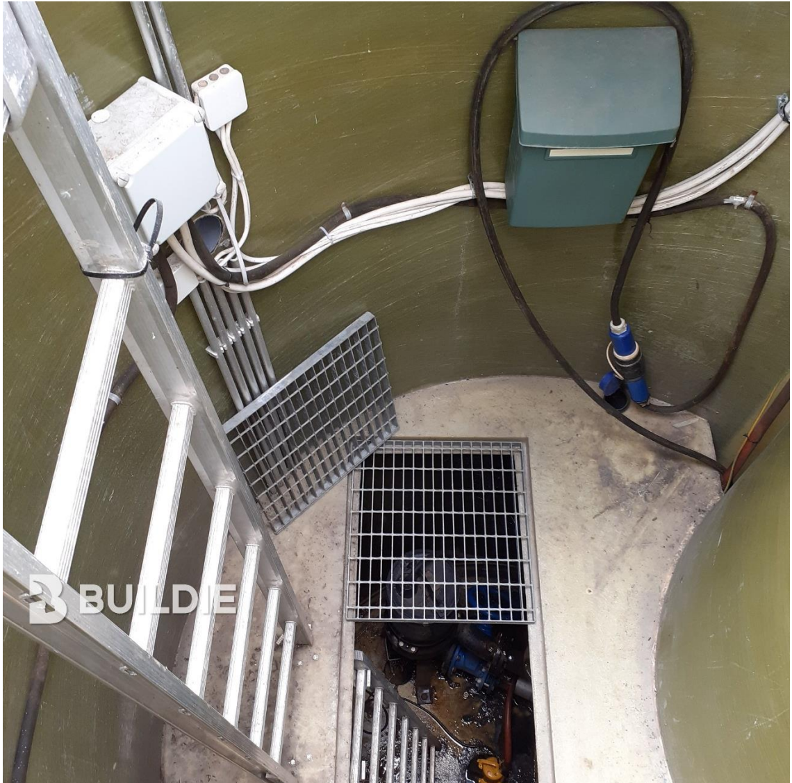
Kuva 18: Pumppaamon sisällä ei saisi olla sinne kuulumatonta tavaraa. Irtonaisille esineille tulee löytyä säilytyspaikka.
