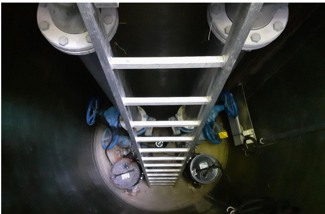
Kuva 8: Turvapumppaamon kuivan puolen alakerta, jossa kuiva-asenteiset pumput sijaitsevat.
