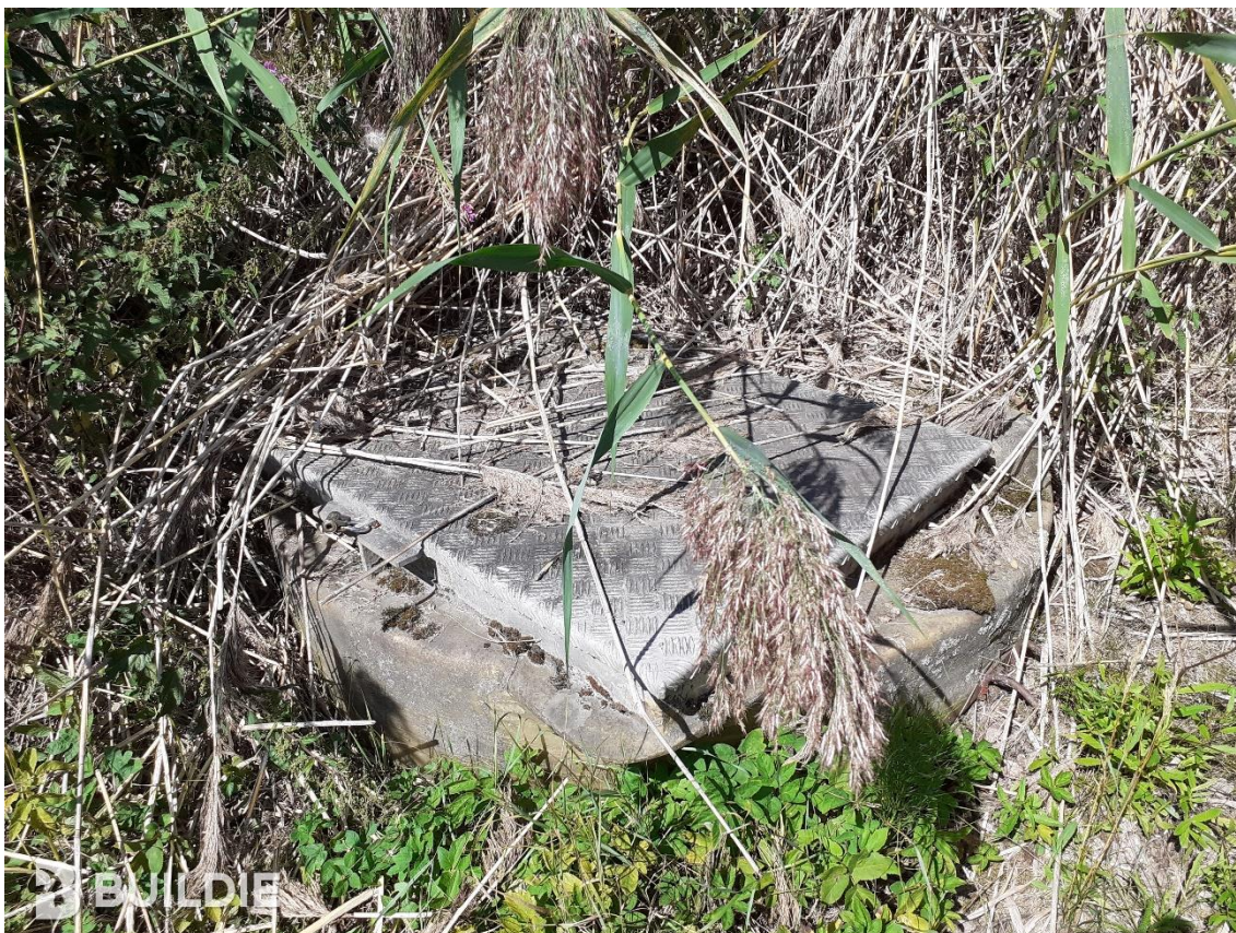
Kuva 1: Pumppaamon säiliön kannen päälle oli kertynyt kasvustoa, josta päätellen säiliön kuntoa ei oltu tarkistettu lähiaikoina.
