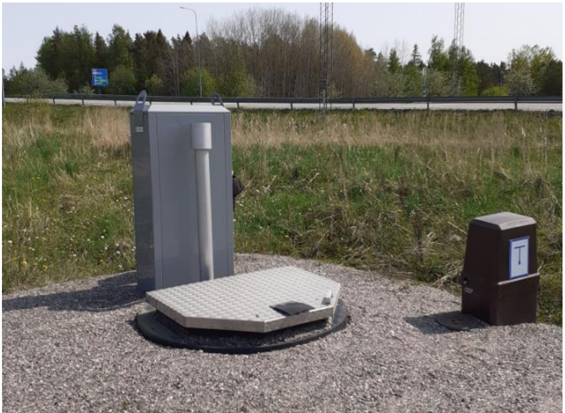
Kuva 4: Säiliöpumppaamon ulkorakenteet. Kuvassa näkyy säiliön luukku, jonka takana on sähkökeskusta suojaava sähkökaappi.
