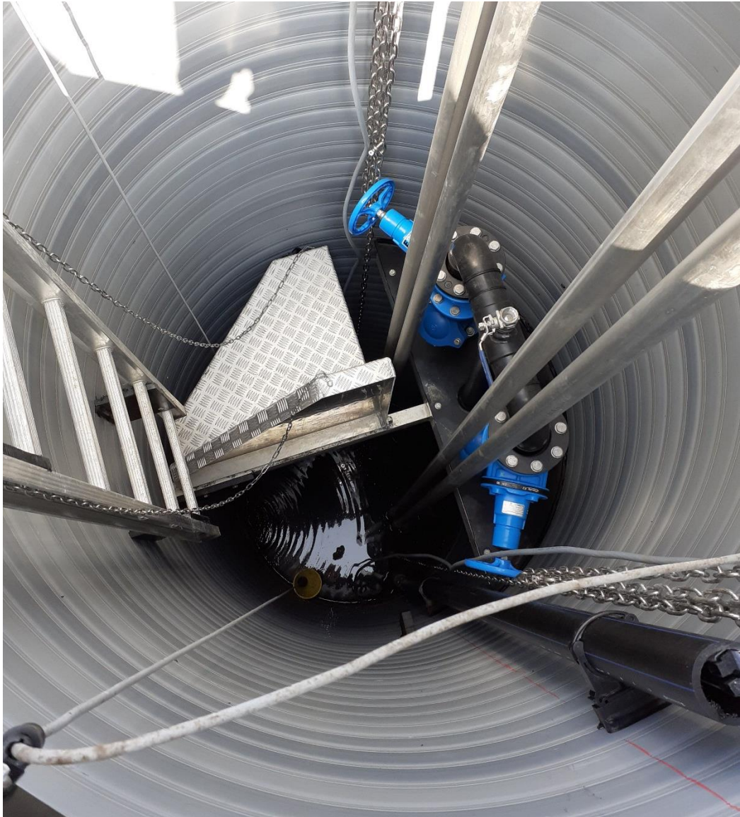
Kuva 5: Säiliöpumppaamo sisältä kuvattuna. Pumput ovat uppoasenteisina veden alla, ja ne voidaan nostaa ylös ketjujen avulla. Pumppaamon sisällä tehtäviä huoltotöitä varten säiliöön on asennettu tikkaat sekä huoltotaso.
