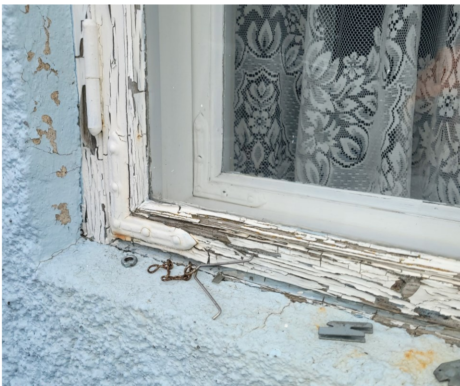
KUVA 21. Lahovaurioitunut kellarin vesipellitön ikkuna.
