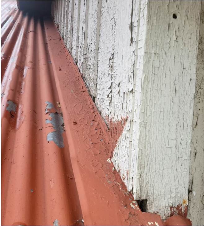
KUVA 29. Seinällennostopelti on asennettu epätiivisti. Seinälle nosto on myös hyvin matala, nykyinen suositus on vähintään 300 mm seinälle.
