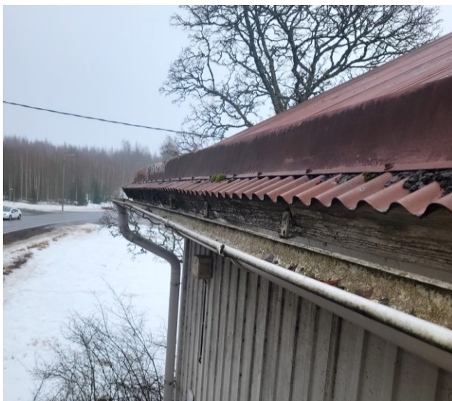
KUVA 26. Sadevesikouru kaataa väärään suuntaan.
