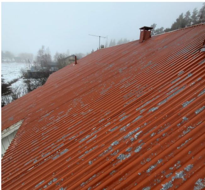
KUVA 25. Maali on irronnut osittain sinkitystä kattopelistä.
