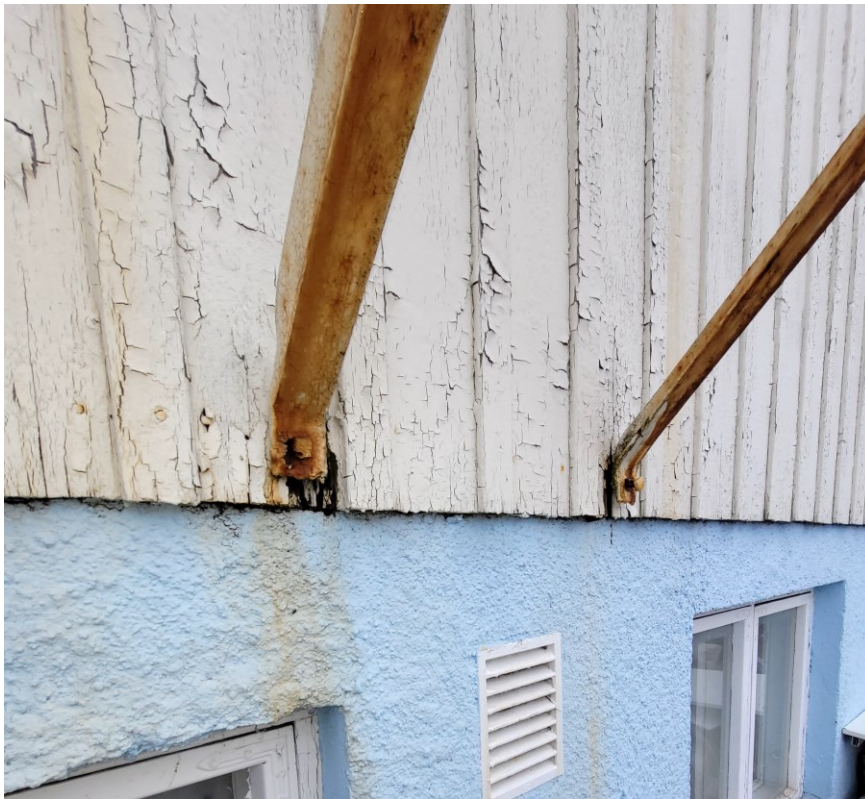
KUVA 19. Seinälaudoitus on lahonnut tikkaiden kiinnitysruuvien kohdalta.
