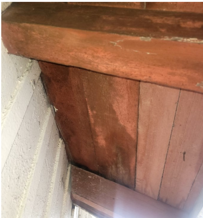
KUVA 30. Umpinainen ja kostea räystäänaluslaudoitus.
