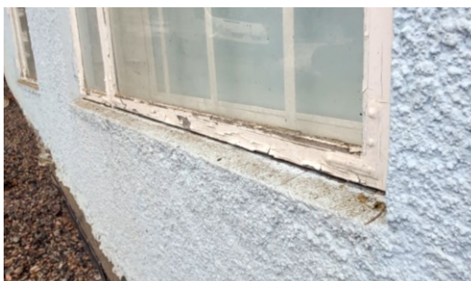
KUVA 39. Ikkunapellityksiä ei ole asennettu
