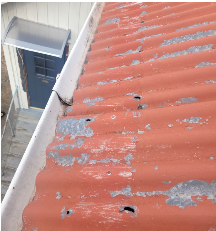
Kuva 28. Reikiä peltikatossa, lumiaste on revennyt irti.
