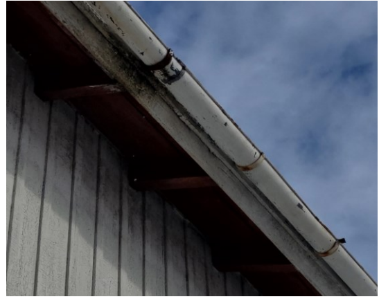
KUVA 28. Ränni vuotaa jatkoksesta
