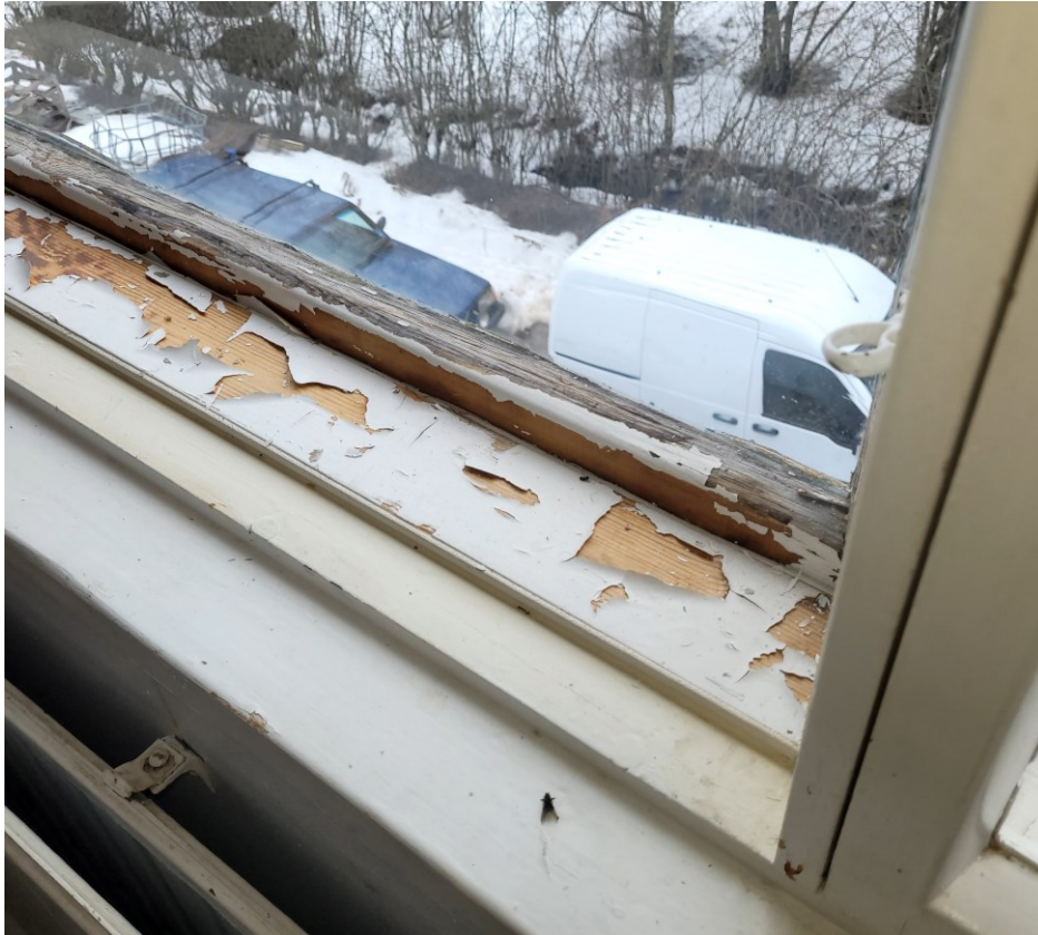
KUVA 22. Maalivaurioita oli nähtävillä kaikissa ikkunoissa.
