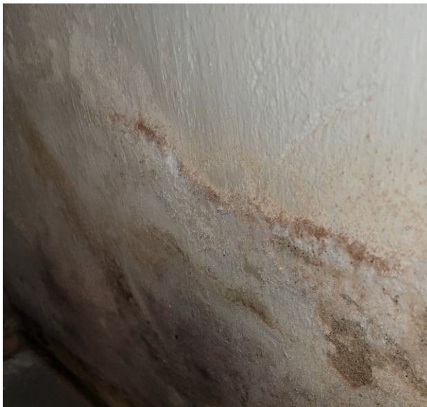
KUVA 39. Kosteusvaurioitunutta seinän alaosa.
