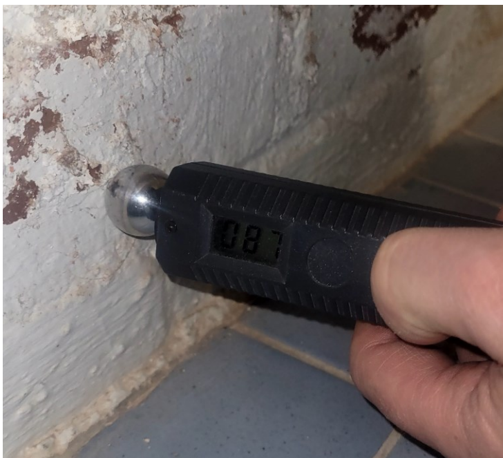
KUVA 36. Seinän ja lattian liitos kohdan pintakosteuskartoitusta.
