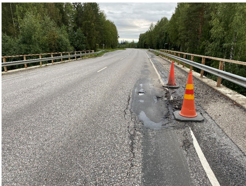
KUVA 22. Päällyste purkautuu ajouran kohdalla. Kuva Olli Nevalainen 2023.
