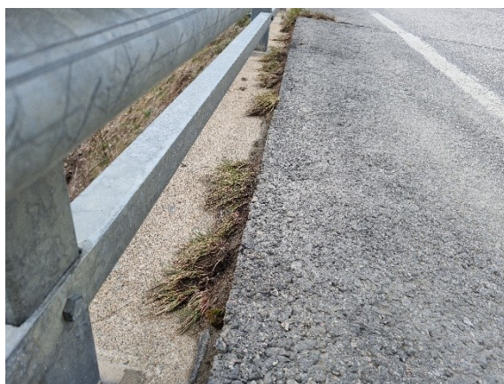
KUVA 23. Reunapalkin ja päällysteen välisen sauman vesivuoto. Kuva Jonne Laakkonen 2022.
