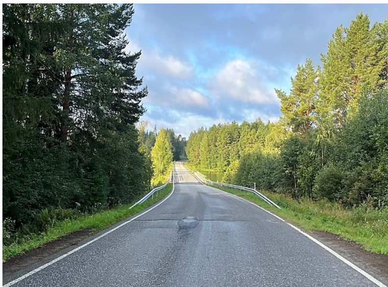
KUVA 21. Tiekaiteen alta poistamaton reunapalle saattaa aiheuttaa siltapaikalle suuren hulevesikuorman ja lisätä eroosiovaurioiden riskiä.
