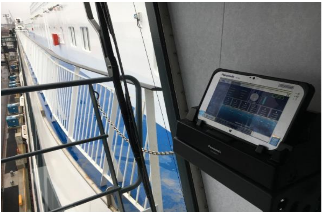
Kuva 10. Cavotecin autonominen kiinnitysjärjestelmän kontrolli paneeli kuvattuna aluksen komentosillalla (Cavotec, 2024).
