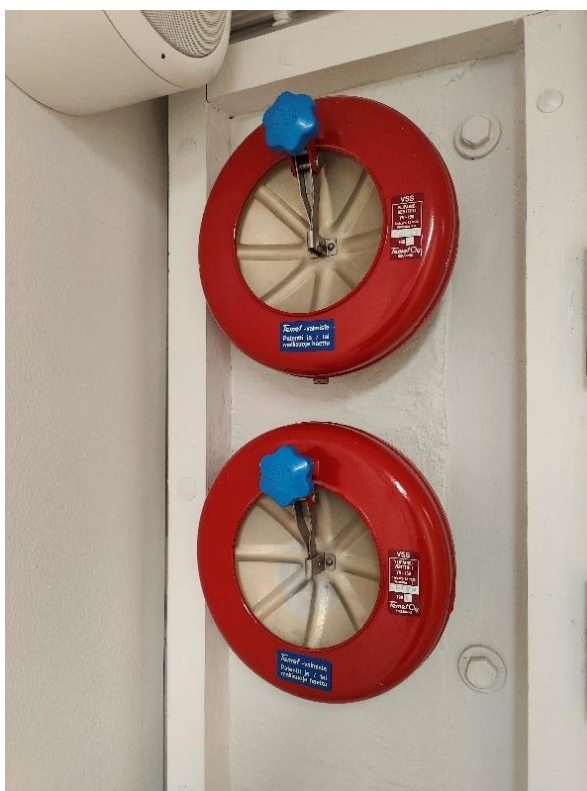
Kuva 17. VSS ylivuotoventtiilien sulkeminen.
