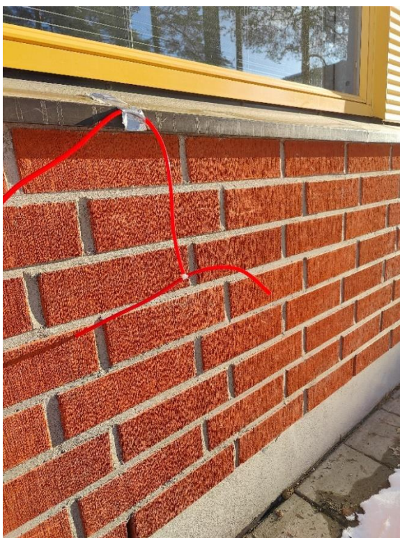
Kuva 26. Ulkona mittauspisteen läheisyydessä sijaitseva t-haarainen paineputki.
