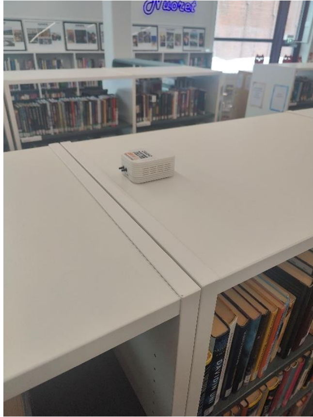
Kuva 36. Kirjaston päätilassa sijaitseva sensori.
