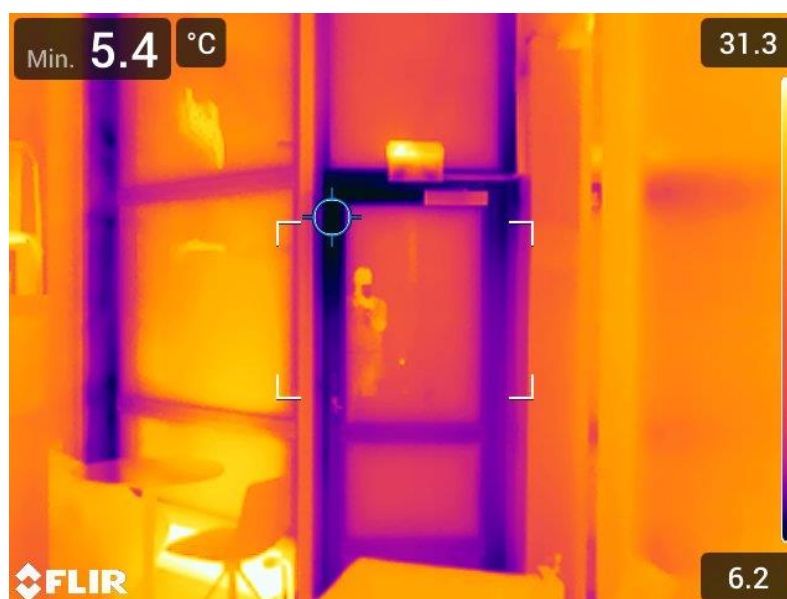
Kuva 32. Kirjaston hätäpoistumistien ilmavuoto.
