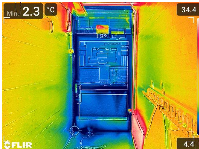
Kuva 34. Nuorisotilan hätäpoistumistien ilmavuoto.
