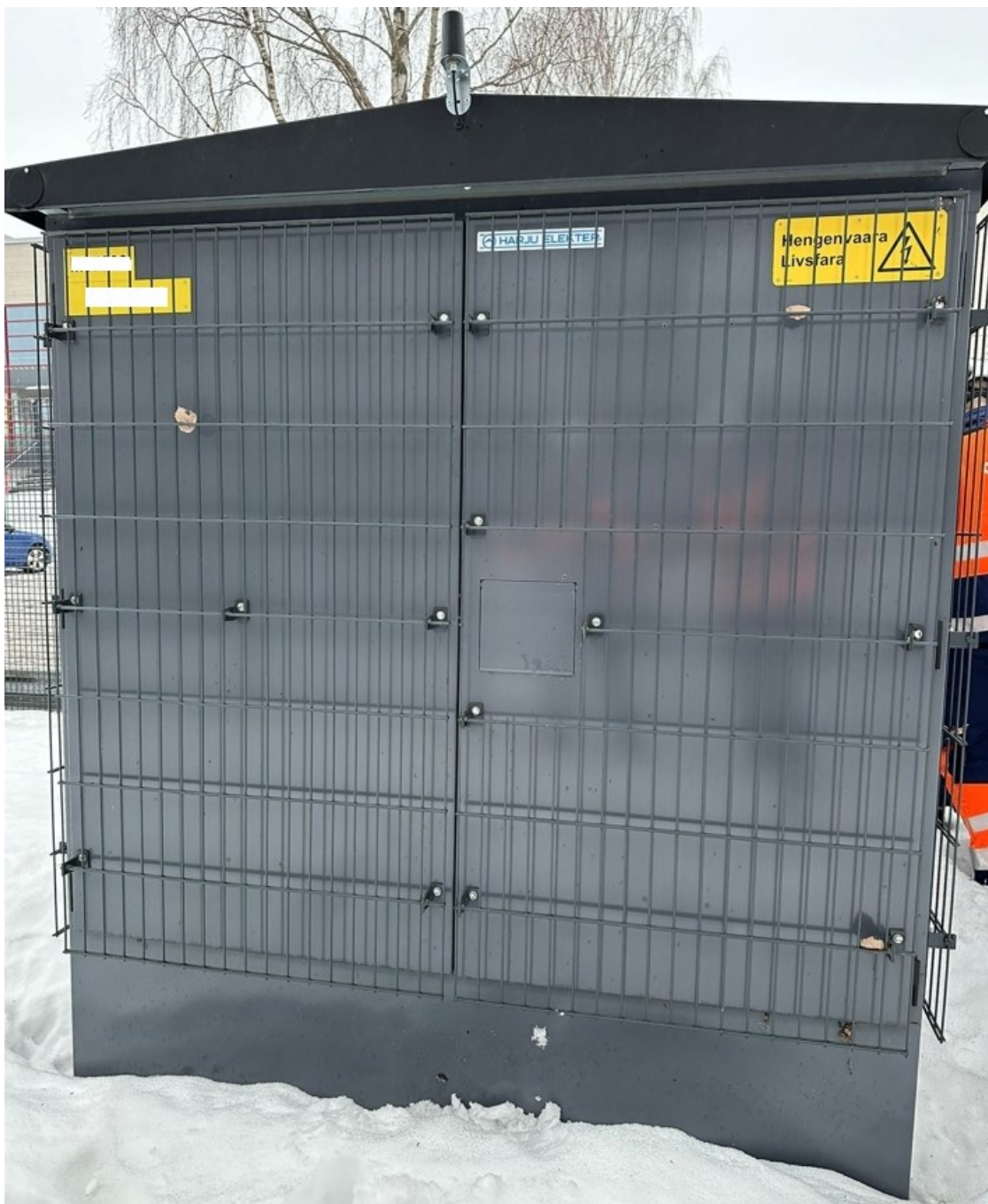
Kuva 7. Kytkemön omakäyttökeskuksen ulkopuoli
