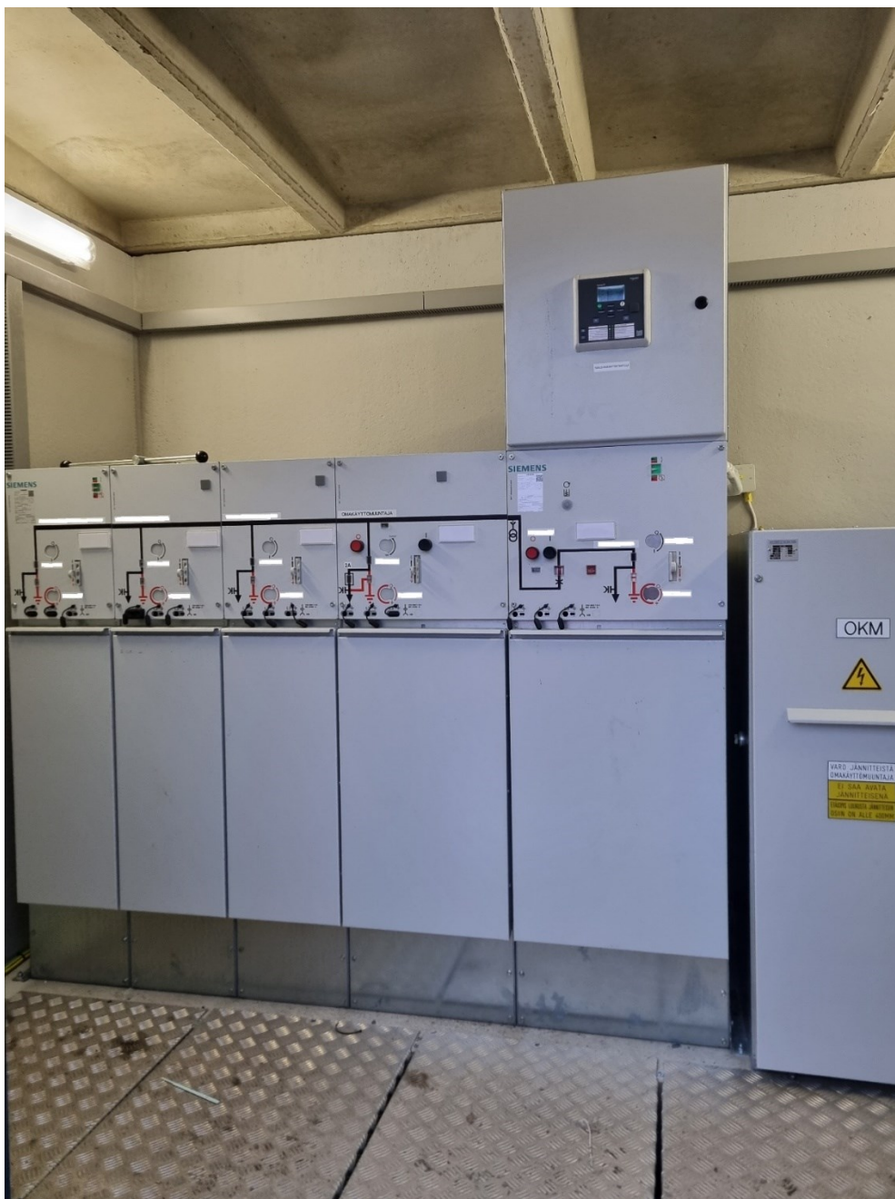
Kuva 9. Kolmen kaapelipäätteen keskijännitekojeisto (Kokkonen 2024)
