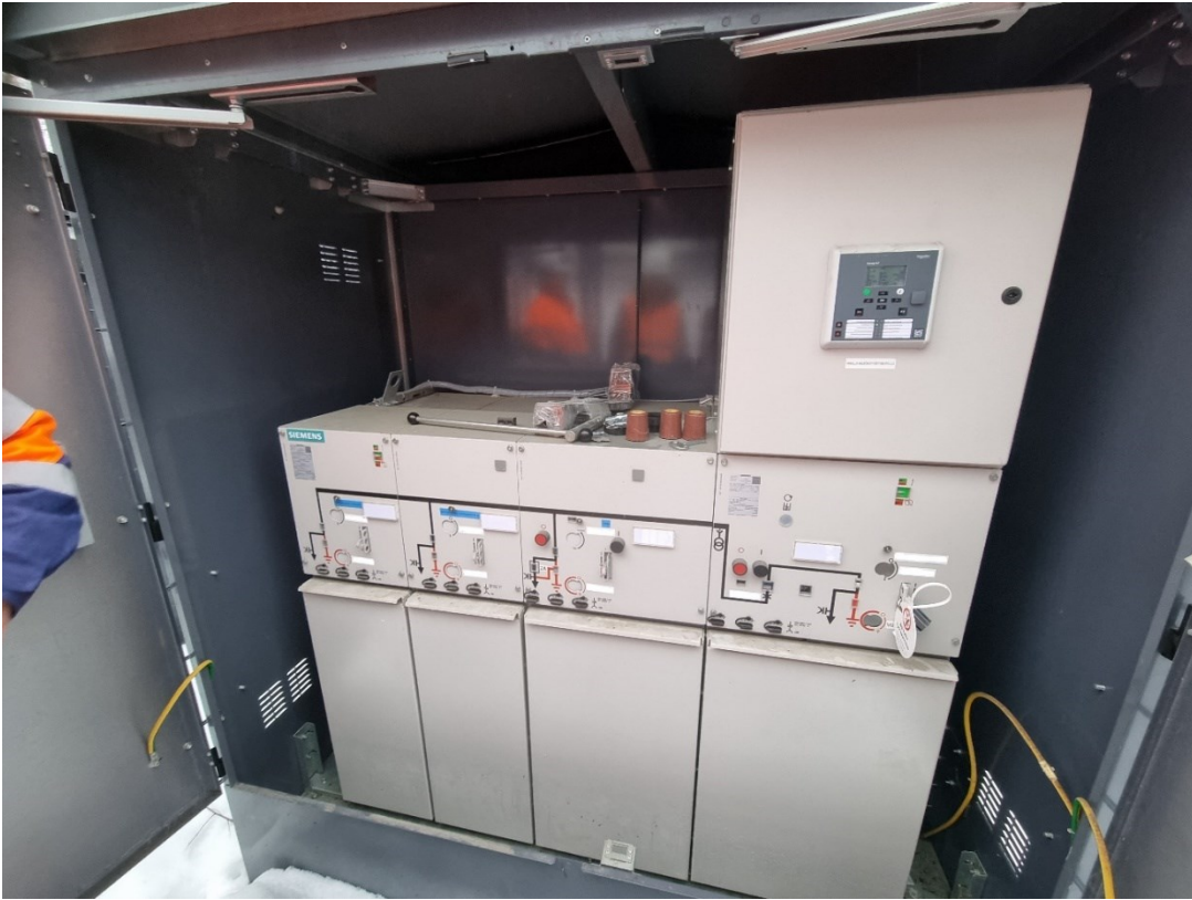
Kuva 8. Kahden kaapelipäätteen keskijännitekojeisto (Kokkonen 2024)
