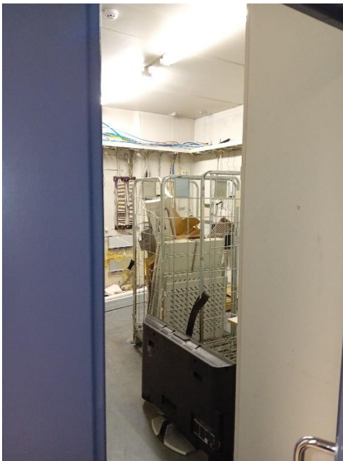
Kuva 3: Lukitsematon telehuoneen ovi
