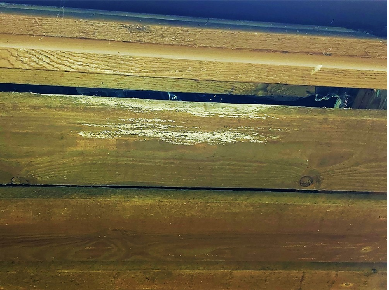
Kuva 1. Räystäään aluslaudoituksen homevaurio (Rakennustaito, 2019)
