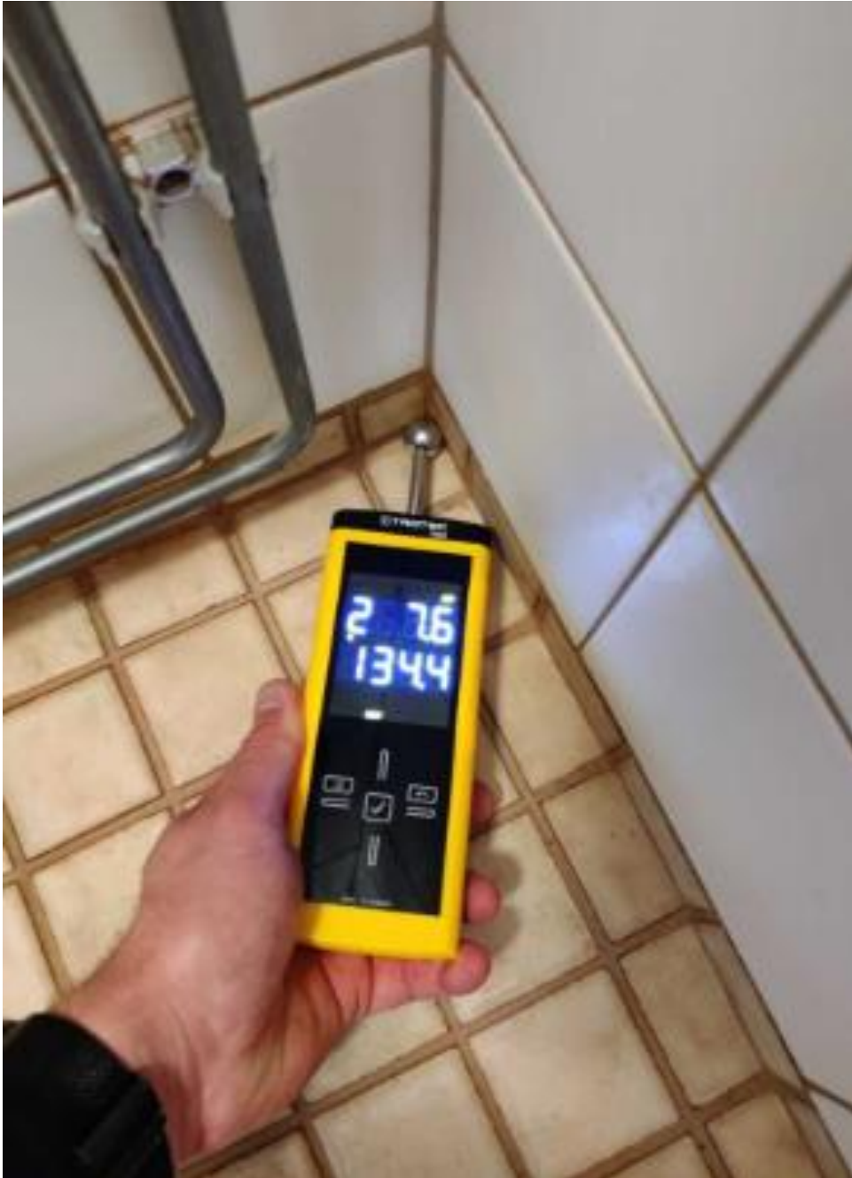
KUVA 16. Suihkunurkkauksessa kohonneita kosteusarvoja seinän ja lattian nurkassa
