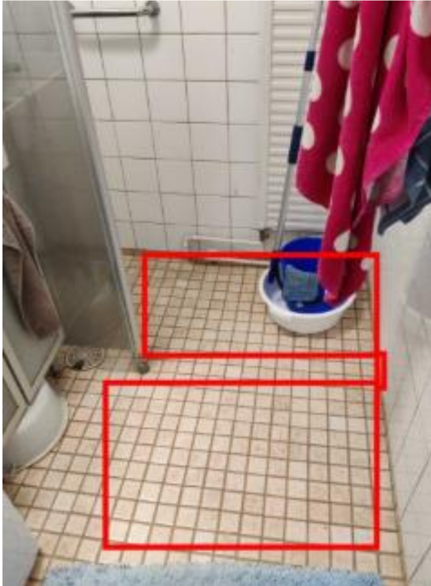
KUVA 13. Kopolaattoja keskellä kylpyhuonetta ja suihkualueella
