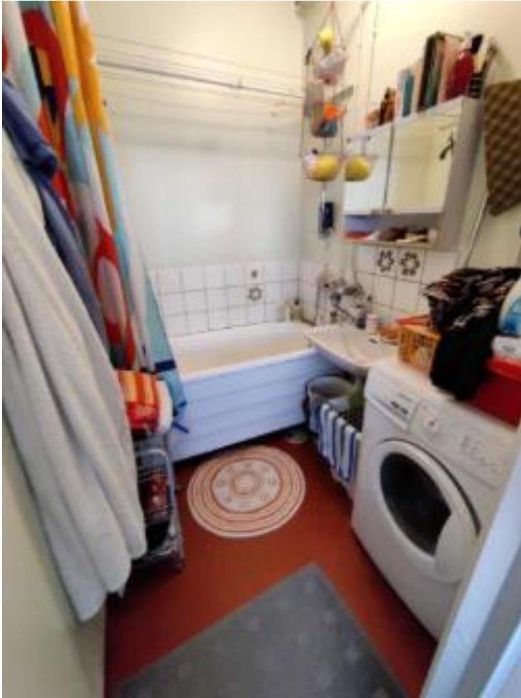
KUVA 7. Alkuperäiskuntoinen kylpyhuone, jossa laatat osittain irti alustastaan.
