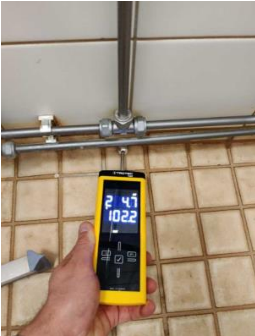
KUVA 15. Lattianrajassa suihkun alla kohonneita kosteusarvoja.
