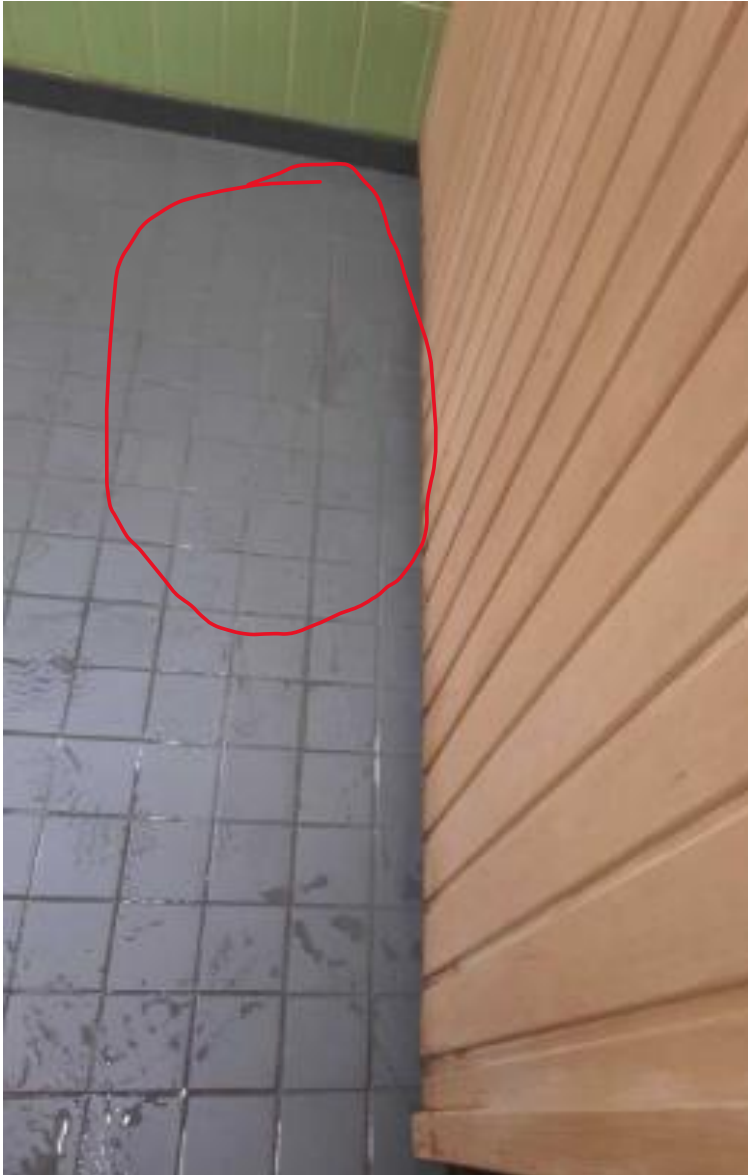
KUVA 18. Vesi lammikoituu merkatulle alueelle
