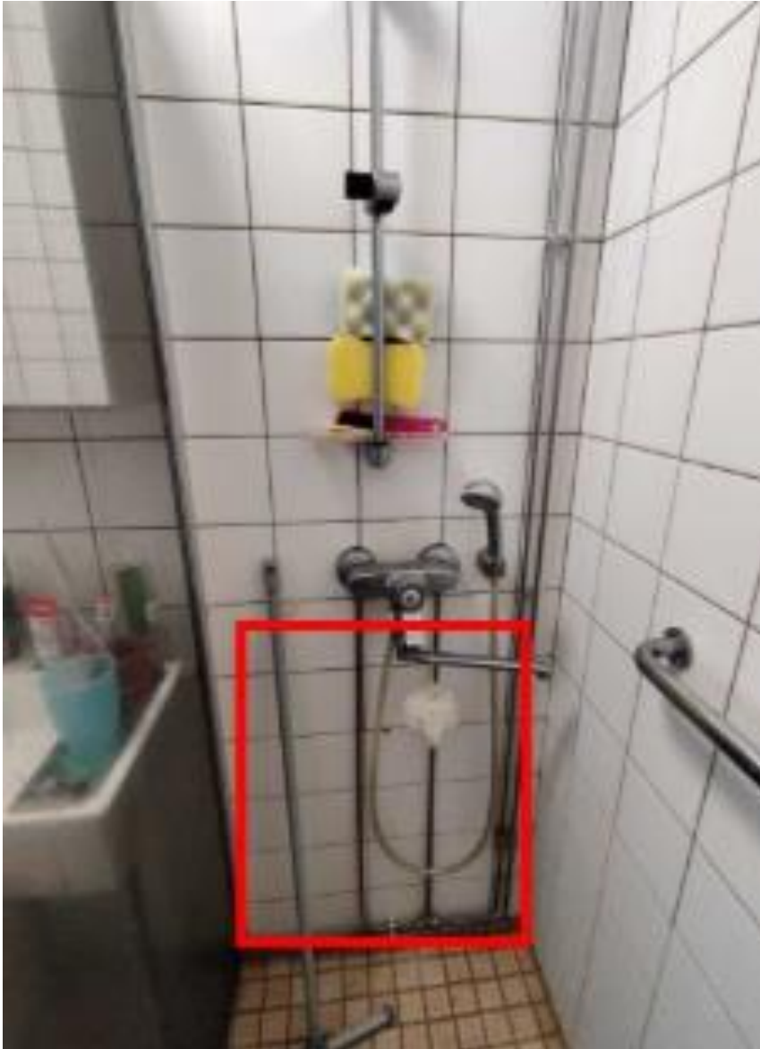
KUVA 8. Merkatulla alueella kopolaattoja. Uusi laatoitus asennettu vanhan muovimaton päälle.
