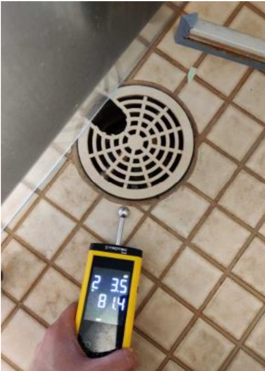
KUVA 14. Kaivon alueella ei kohonneita kosteusarvoja
