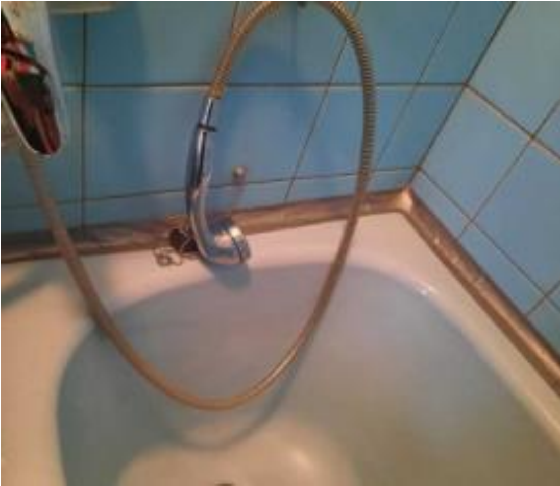
KUVA 11. Kylpyammeen ja seinän välinen sauma tiivistetty ilmastointiteipillä.
