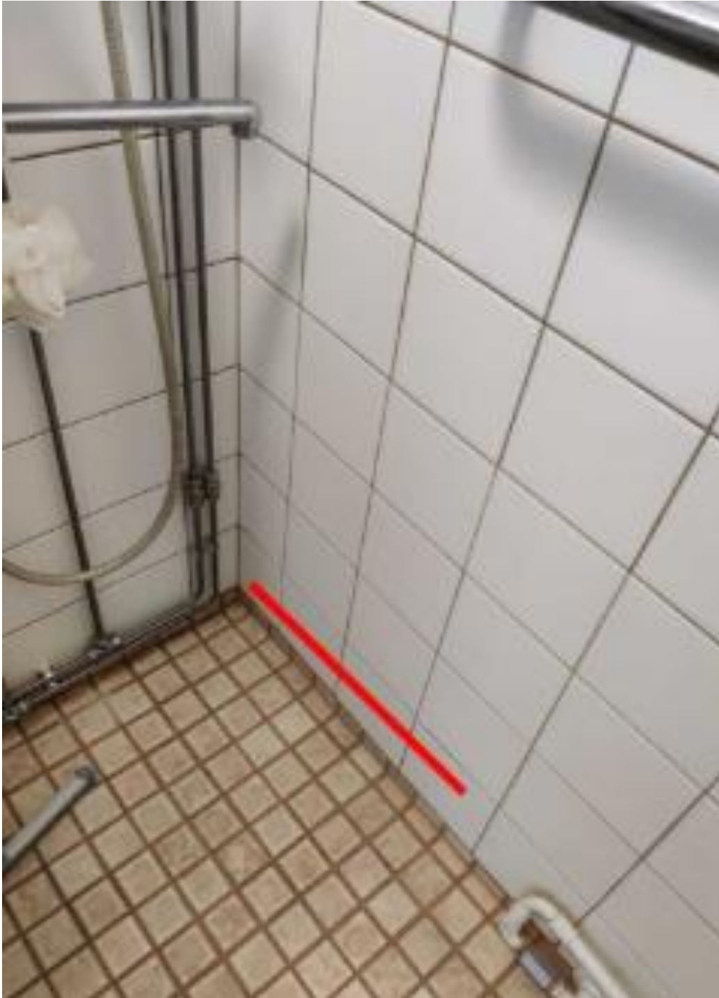
KUVA 9. Merkatulla alueella kopolaattoja. Uusi laatoitus asennettu vanhan muovimaton päälle.
