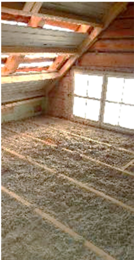
Kuva 57. Puhallusvillaeristeen asennustyöt kattorakenteiden kohdalla on suoritettu kosteudenhallintakoordinaattorin valvonnan alla (kuvaaja: Wafa Ameli).
