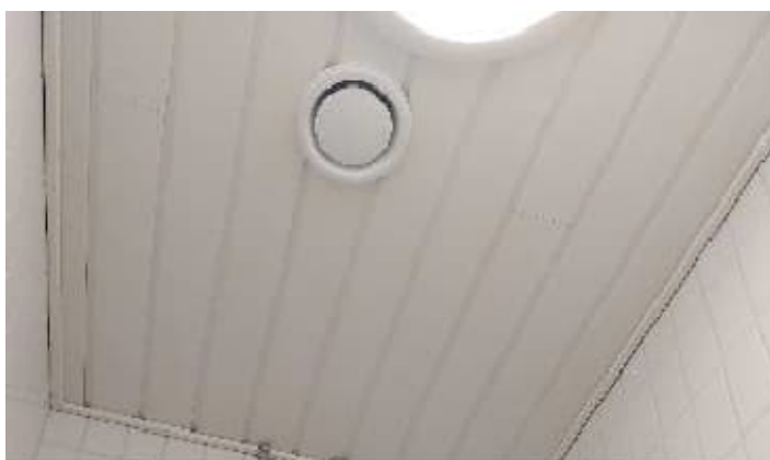
Kuva 81. Iv-poistoventtiili suihkun katossa on asennettu annettujen ohjeiden mukaisesti.
