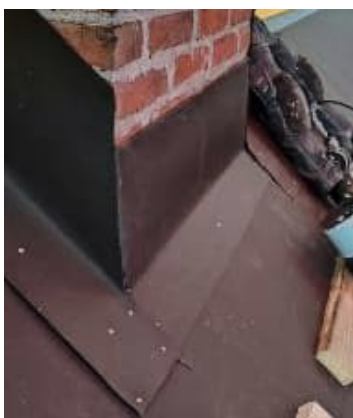
Kuva 74. Katossa on piipun läpivienti, jonka yhteydessä alushuopa on nostettu läpiviennin reunaan 300 mm saakka.
