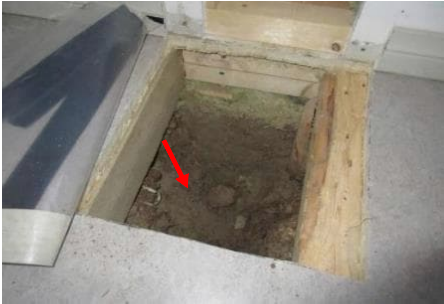
Kuva 11. Alapohjan puurakenteet ja täyttömateriaalit olivat aistinvaraisesti ja kosteusmittauksilla arvioituna kuivia. Yhden tilan turve-eristetäyttömateriaalissa todettiin kohonnut homesieni-itiöpitoisuus. Lattian liittymät seinärakenteisiin eivät ole ilmatiiviitä [16].
