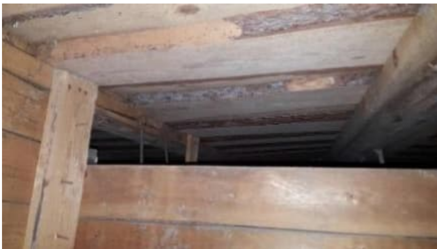
Kuva 12. Tuulettuva alapohjatilaa tarkasteltiin pistokoelunteisesti sokkelin tuuletusaukkojen kautta. Alapohjan puurakenteiden kosteusteknisessä kunnossa ei huomautettavaa [16].
