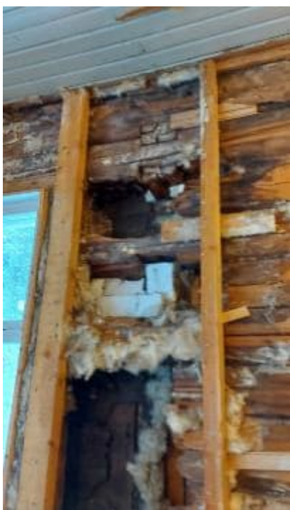
Kuva 41. Seinärakenteissa on havaittavissa laajoja lahovauriota. Hirsirakenne on paikallisesti kadonnut kokonaan (kuvaaja: Wafa Ameli).
