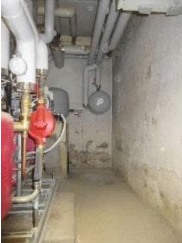
Kuva 16. Kellarin seinäpintojen maali- tasoitepinnat ovat kuluneita. Seinien alaosissa on kosteutta ja kosteuden aiheuttamia pintavaurioita [16].
