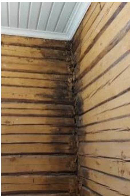
Kuva 42. Nurkkakohdissa on tummumaa ja seinä-seinäliittymästä on havaittavissa viitteitä kosteusvauriosta (kuvaaja: Wafa Ameli).
