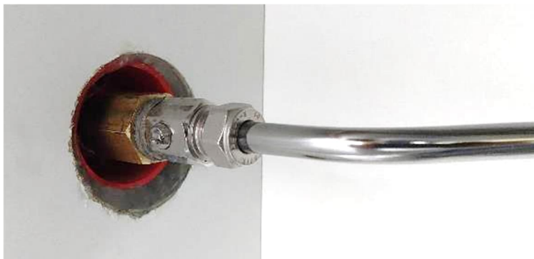
Kuva 83. Muoviset vesiputket keittiön Allaskaappiin hanakulmat tiivistetty kalusteen levypintaan. Allaskaapissa on asennettu vuotokaukalo pohjalla [19.].
