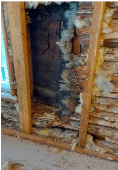
Kuva 40. Seinärakenteissa on havaittavissa laajoja lahovauriota. Hirsirakenne on paikallisesti kadonnut kokonaan (kuvaaja: Wafa Ameli).
