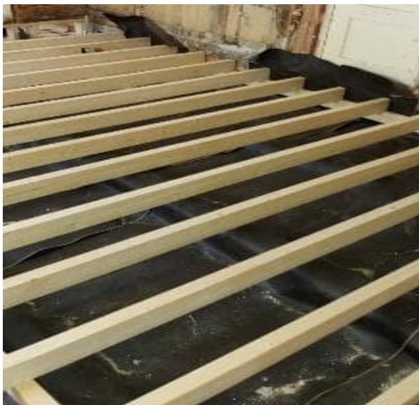
Kuva 47. Alapohjan vedeneristerakenteet uusitaan kokonaan (kuvaaja: Wafa Ameli).
