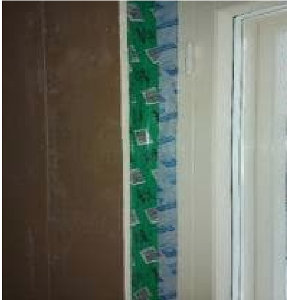
Kuva 52. Työn laatu tulee vastata materiaalitoimittajan antamia ohjeita (kuvaaja: Wafa Ameli).
