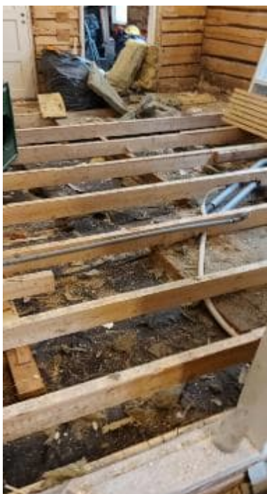
Kuva 39. Lattiarakenteiden purkuvaihe. Osassa lattian eristerakenteissa on havaittavissa tummumaa (kuvaaja: Wafa Ameli).
