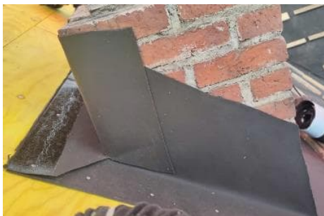
Kuva 75. Katossa on piipun läpivienti, jonka yhteydessä alushuopa on nostettu läpiviennin reunaan 300 mm saakka.
