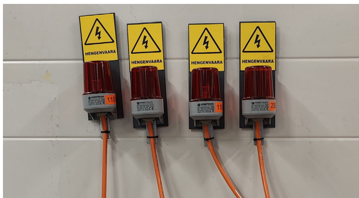
Kuva 8. Kaapeleilla vaiheeseen yhdistettäviä varoitusvaloja.
