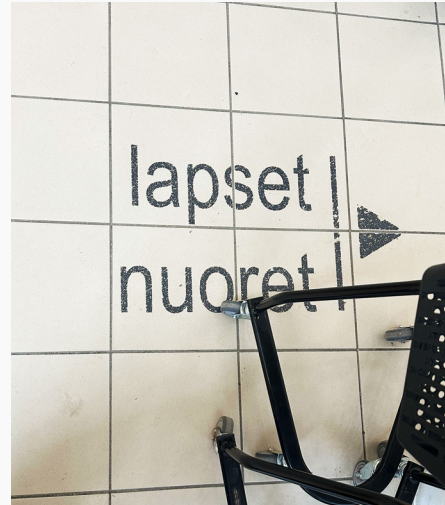
Kuva 43. Kulkuväylällä kulunut lattiaopaste
