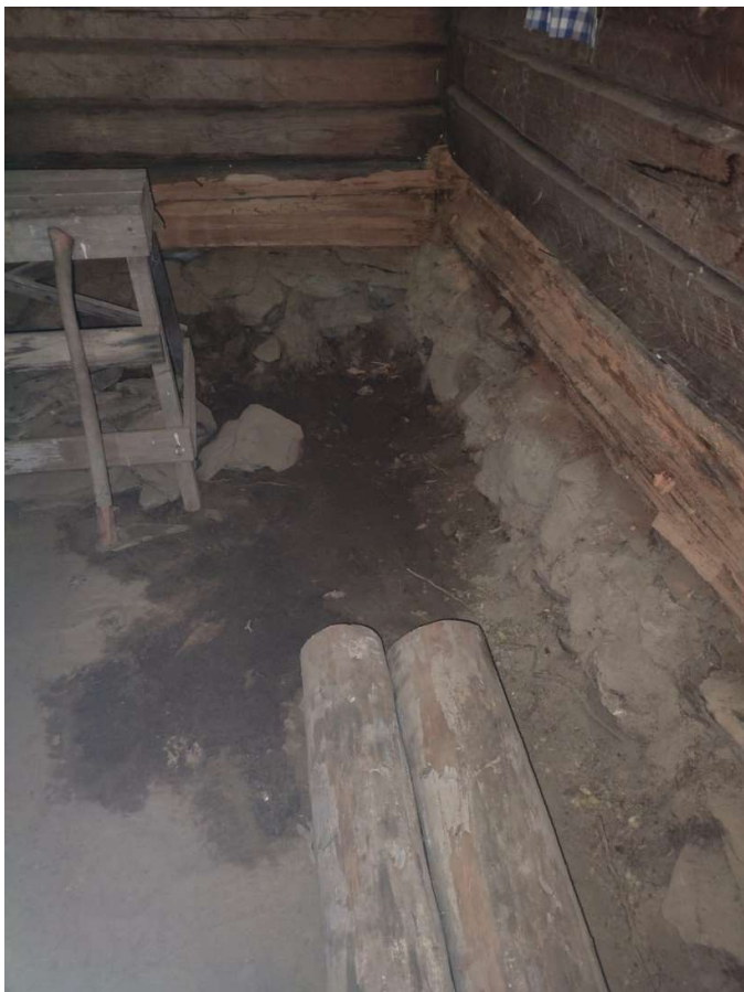
Kuva 11. Lumen sulamisvedestä tullut märkä kohta tuvassa (Kuva: M.R.).
