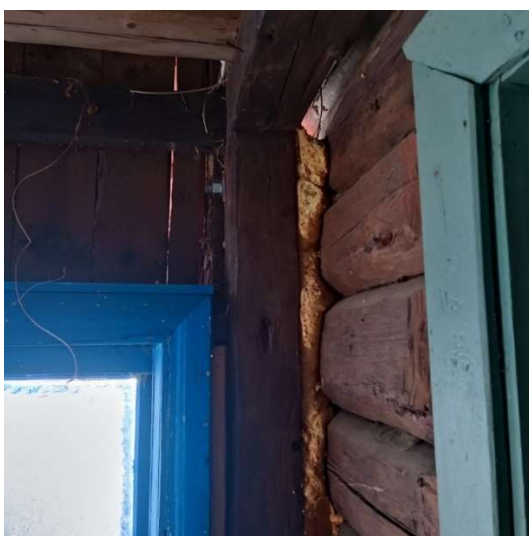
Kuva 19. Kuistin liikkunut rakenne (Kuva: M.R.).
