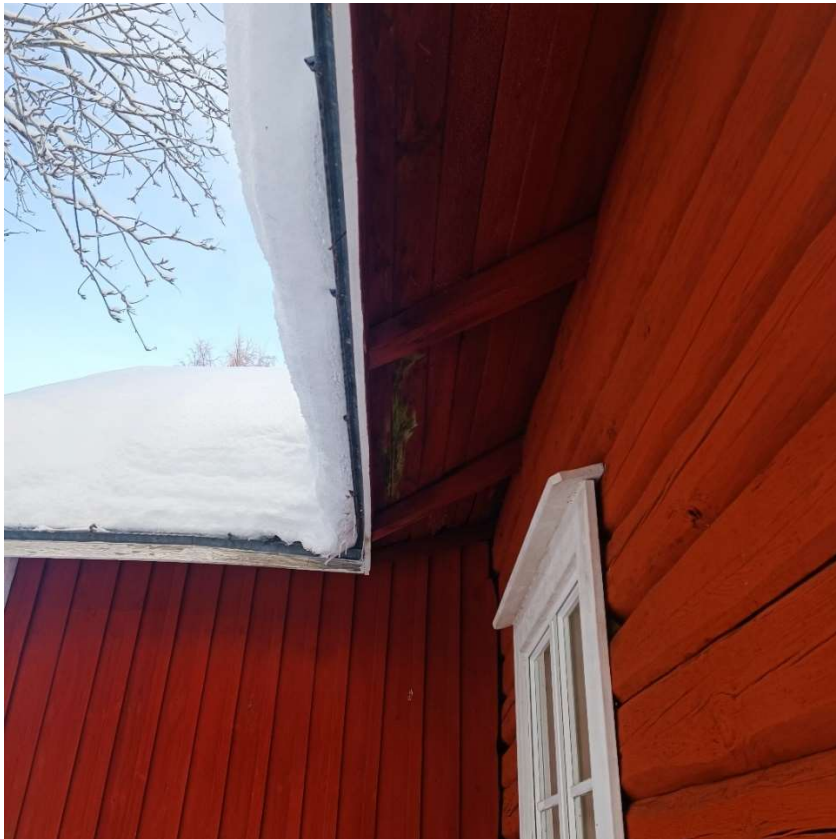
Kuva 29. Vuotokohta vesikatossa, räystäslaudoituksessa talon ulkopuolella (Kuva: M.R).
