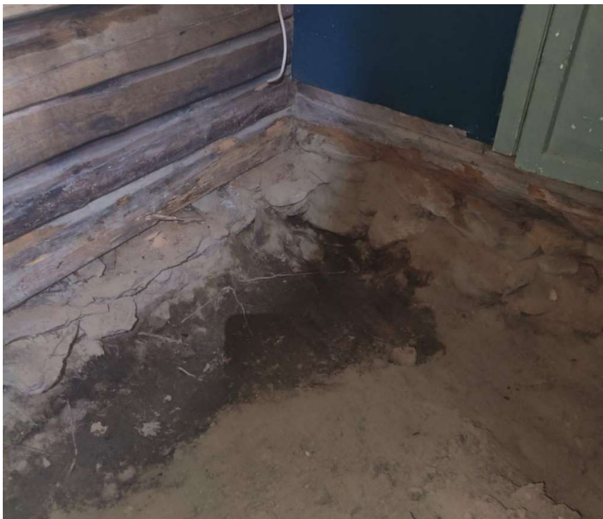
Kuva 10. Lumen sulamisvedestä tullut märkä kohta uunin vieressä (Kuva: M.R.).
