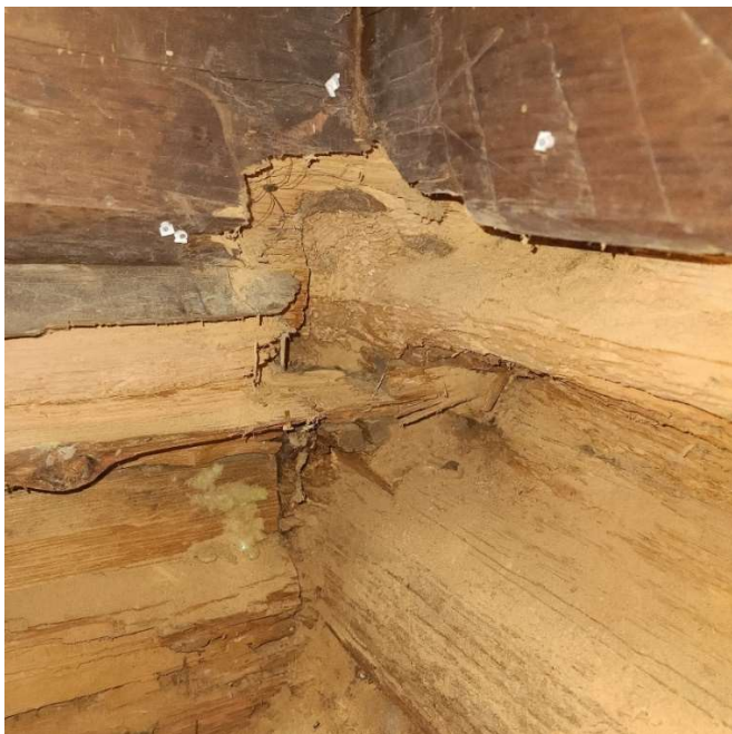
Kuva 14. Lahovaurioita tuvan puolella alimmissa hirsissä (Kuva: M.R).
