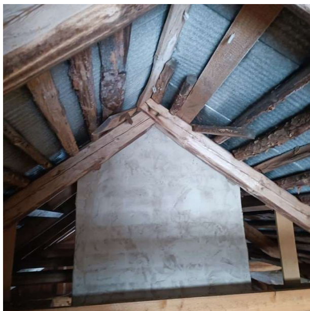
Kuva 25. Vesikaton ruodelaudat ovat katonharjan luota pettäneet ja kattopelti on päässyt notkolle (Kuva: M.R).
