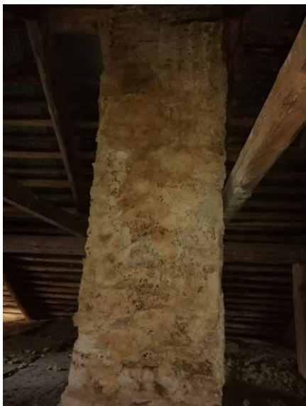
Kuva 23. Uunin hormin kuntoa (Kuva: M.R).
