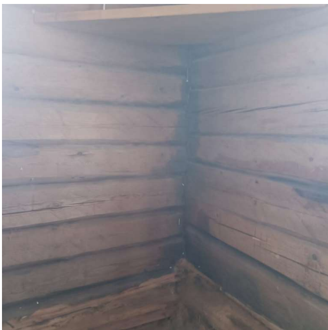
Kuva 15. Kosteuden aiheuttamia tummia kohtia tuvan nurkissa (Kuva: M.R).
