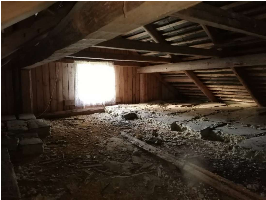
Kuva 26. Yläpohjassa eristeenä ollutta lasivillaa ja sahanpurua (Kuva: M.R).
