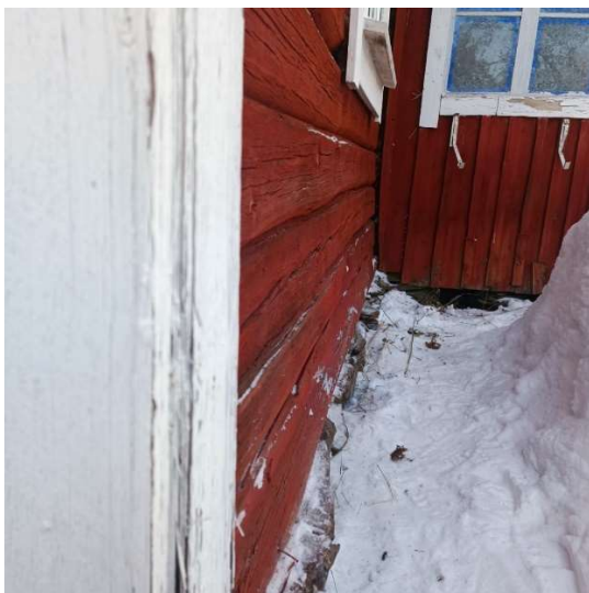
Kuva 17. Alahirret ovat pullistuneet ulospäin (Kuva: M.R).
