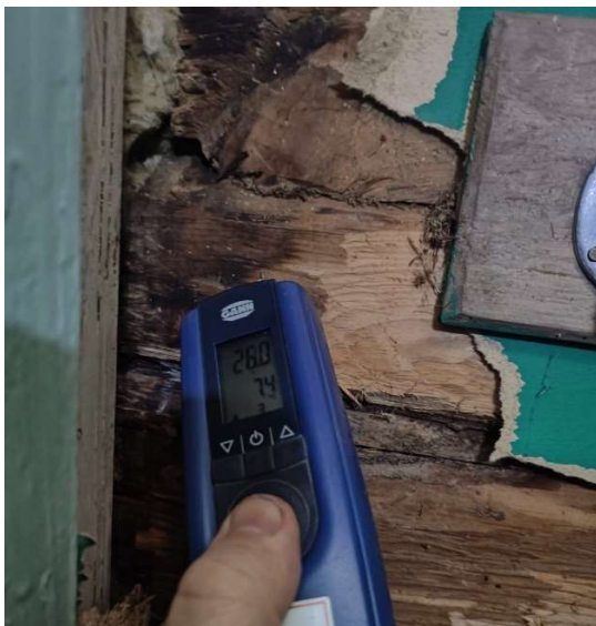
Kuva 16. Kamarin kaapin ovenkarmin vierestä otettu kosteusmittaus (Kuva: M.R).
