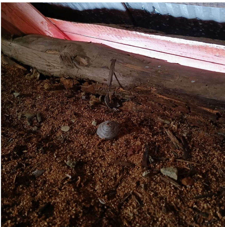
Kuva 28. Yläpohjassa oleva ylin hirsi on lahovaurioitunut (Kuva: M.R.).
