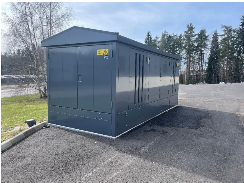
Kuva 18. Muuntamo rakennuksen pihalla.
