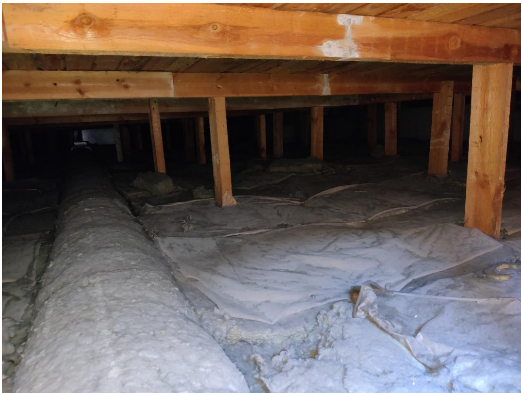
Kuva 11. Itse otettu kuva vesikaton yläpohjasta, jossa kantavat rakenteet ovat tuettu kantavaan teräsvetonilaattarakenteeseen.
