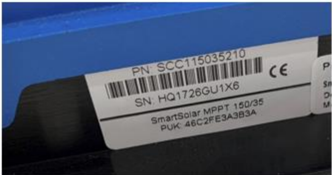
Kuva 14. Aurinkopaneelin lataussäätimen datakilpi.
