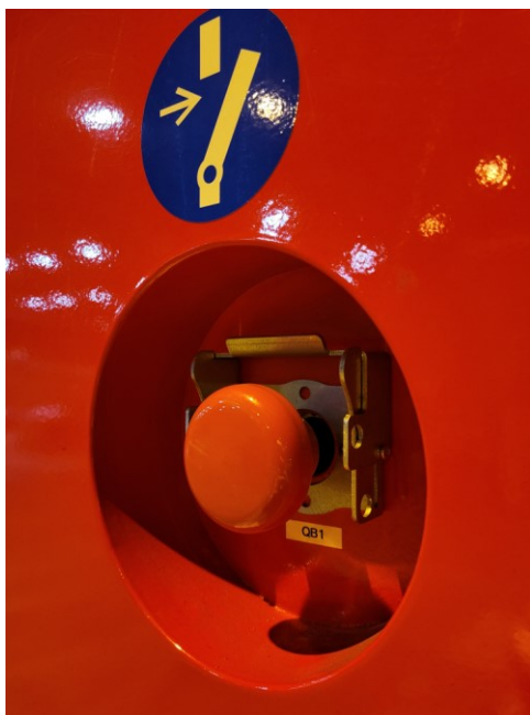
Kuva 14. Lukittavissa oleva pääkytkin.
