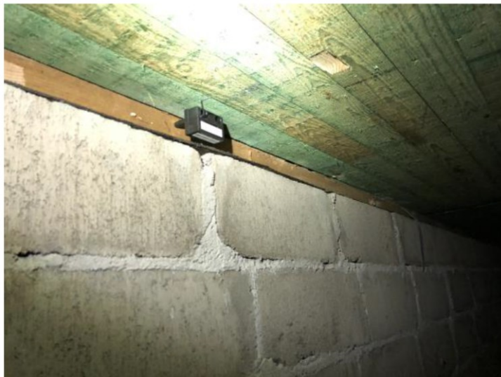
Figur 2: Behandlad syll, ljusbrun, samt behandlad takpanel, grön, i krypgrund. (Lorentzen m.fl. 2024).
