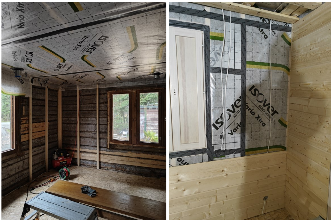
Figur 12 och 13: Montering av lufttätningsskiktet Isover Vario Xtra på tak och väggar. Tätning görs med anpassad tejp och ovanpå skiktet monteras nytt ytskikt såsom panel på väggarna.
