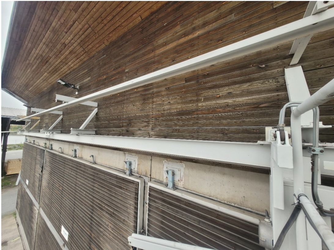
Kuva 8. Valokuva ovensiirtolaitteen palkeista, joita pitkin laite liikkuu.
