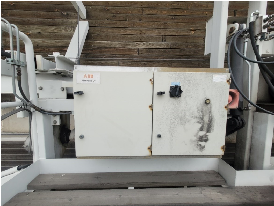
Kuva 10. Valokuva ovensiirtolaitteen kytkentäkoteloista ja pääkytkimestä.
