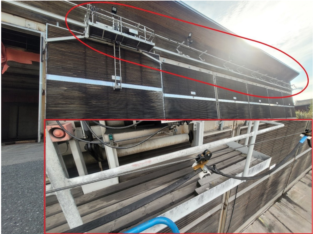
Kuva 9. Valokuva ovensiirtolaitteen sähkönsyötöstä kahdesta eri kuvakulmasta.
