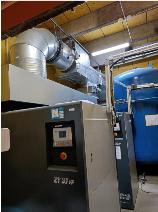
Kuva 14. Linnanmaan kampuksen paineilmakeksus
