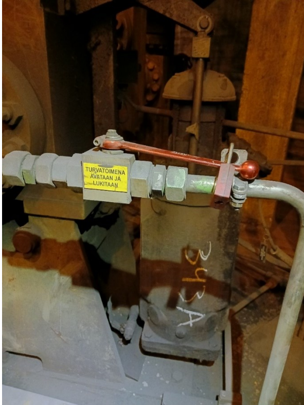
Kuvio 8. Hilsepesurin runkolinjan tyhjennysventtiili lukittuna
