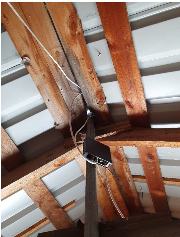
Tiivistämätön antennin putki Aluskate puuttuu
