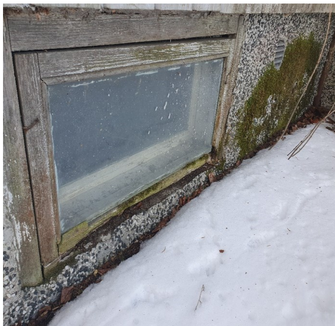
Huonokuntoinen kellarin ikkuna, sammalkasvustoa perusmuurissa
