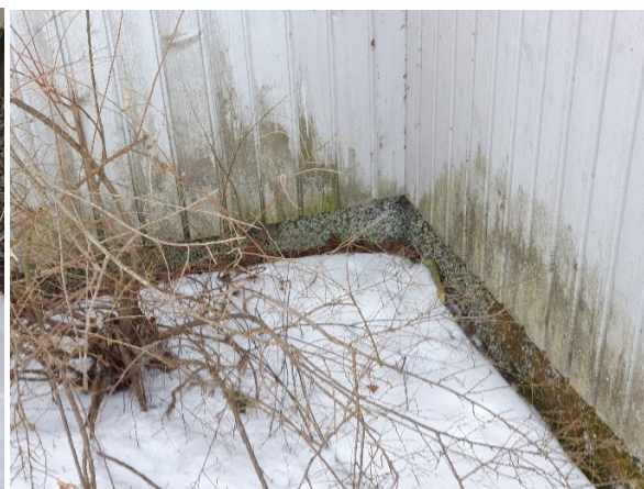
Roiskeveden aiheuttamia vaurioita ulkovuorauksessa ja sokkelissa
