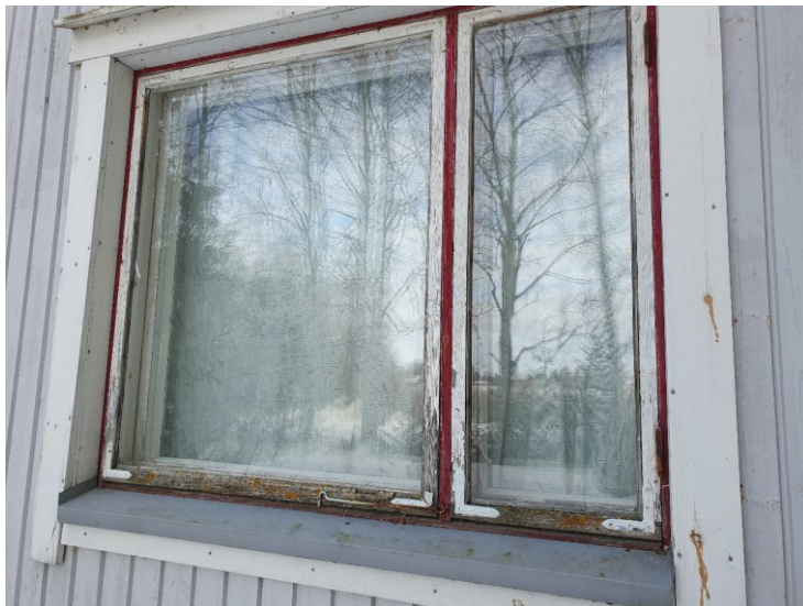
Ikkunoiden puuosat ovat huonokuntoiset
