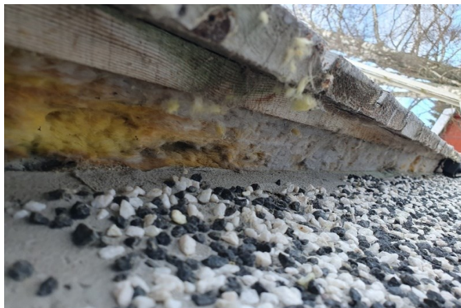
Ulkoverhouksen puutteellinen tuuletusväli
