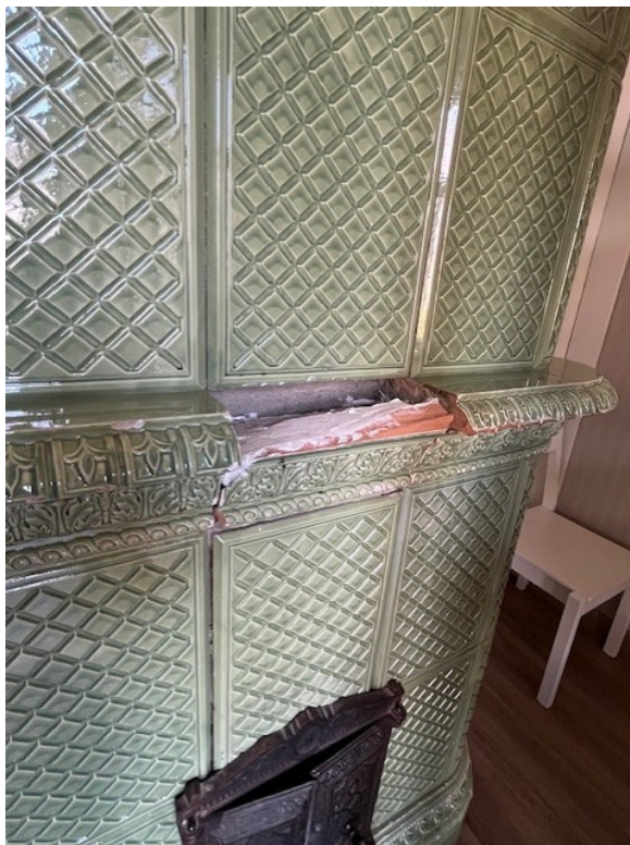
KUVA 59 Kaakeliuunin vaurioitunut reunus (Kuva: Anna Ainassaari, 2024)
