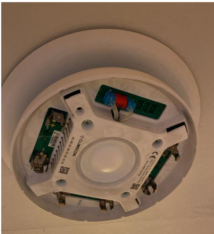
Kuva 12. Venttiili, jonka paristot on poistettu.
