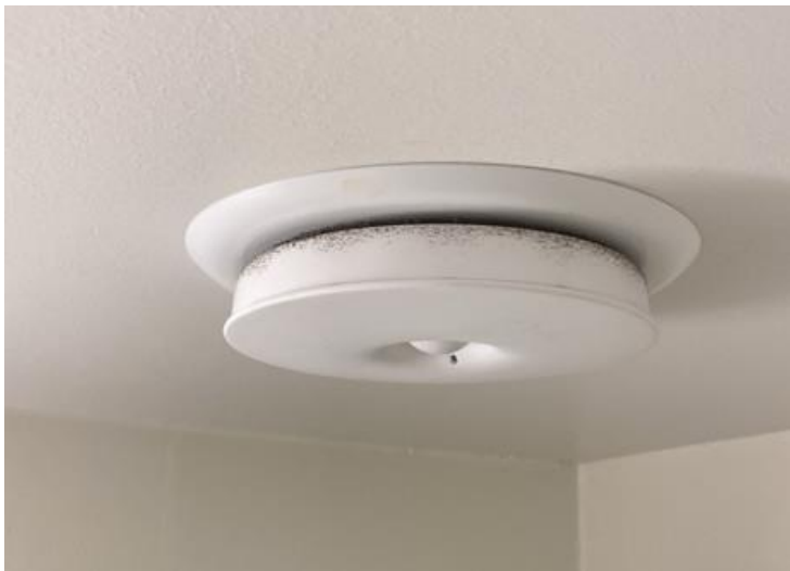
Kuva 9. Venttiili ennen resetointia.
