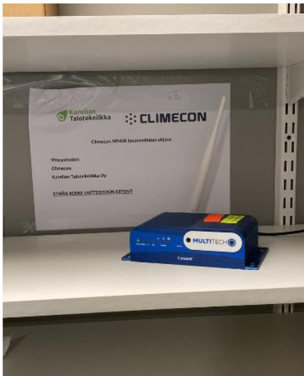
Kuva 13. Venttiilien kanssa keskusteleva keskusyksikkö.
