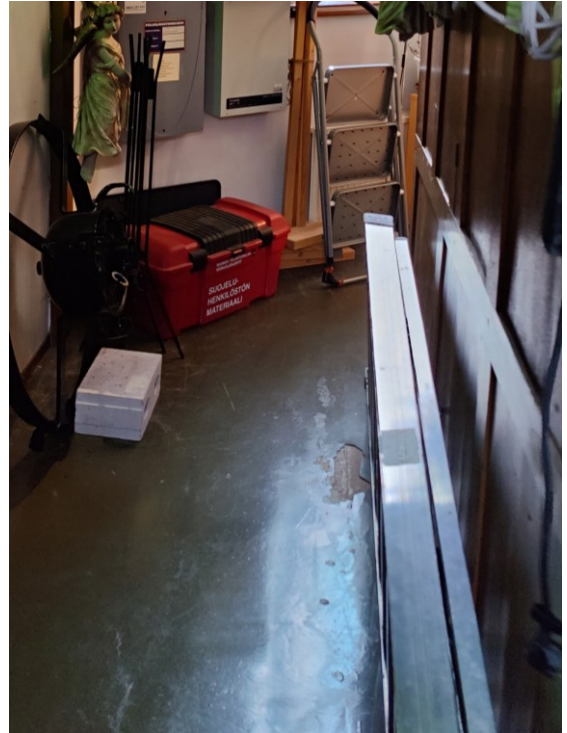
Kuva 48. Kuoriosan lattiassa havaittavissa lohkeilua. (Kuva: Tilda Varttila)
