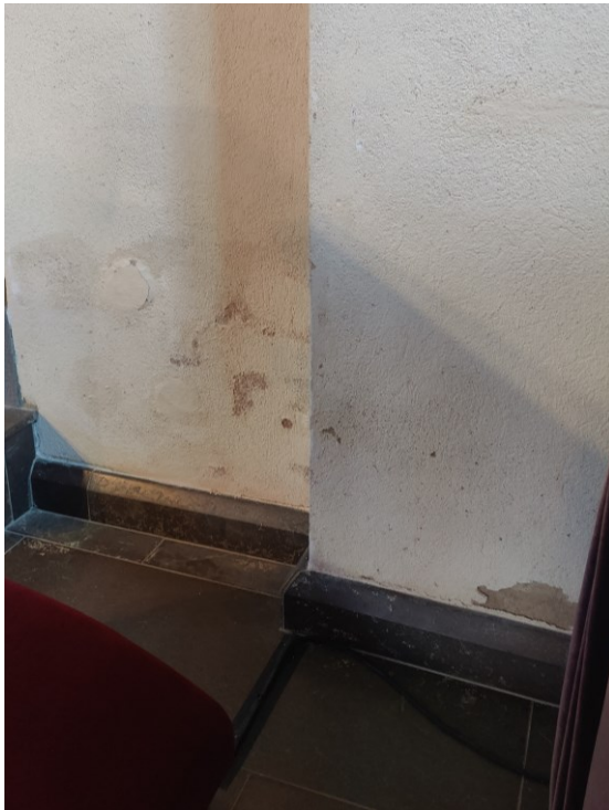
Kuva 47. Alttarin viereisen seinän maalipinnan lohkeilua. (Kuva: Tilda Varttila)
