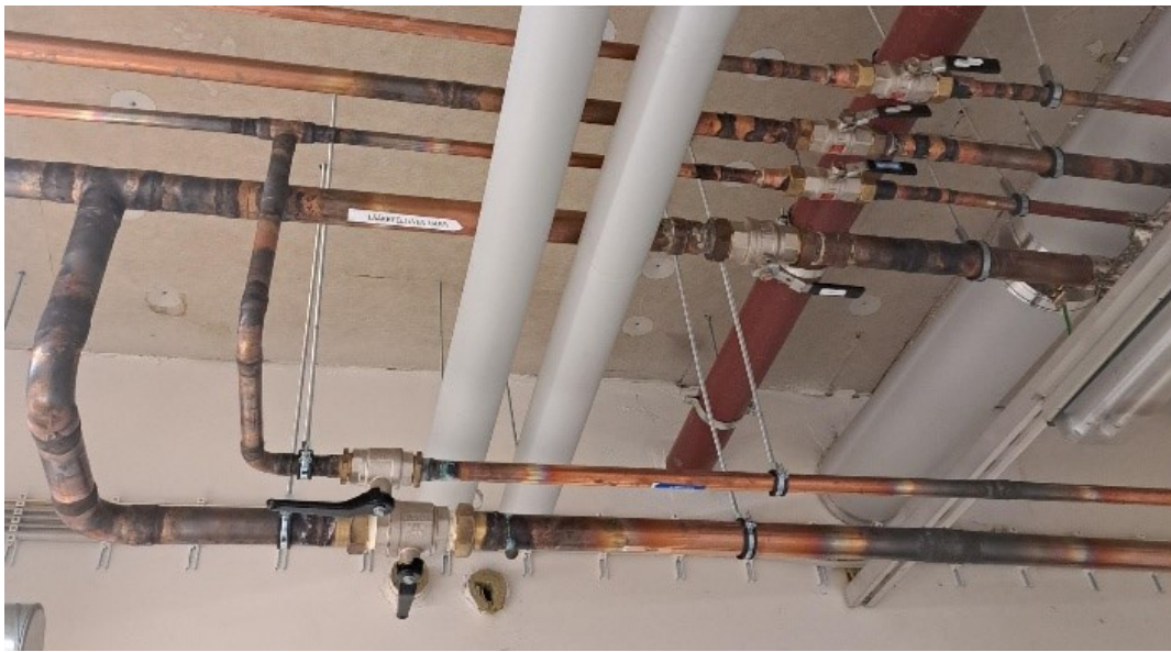
Kuvio 17. Kaasunjakeluverkoston pääkeskuksen sulkuventtiilit
