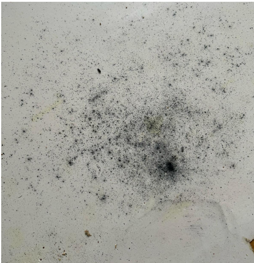
Kuva 6. Lattiassa selkeä mikrobikasvusto.
