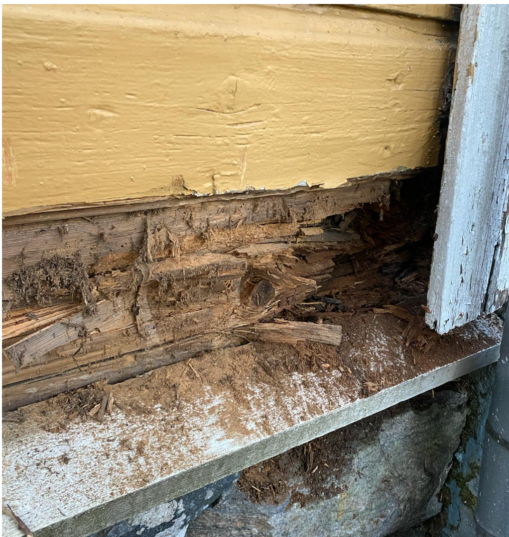
Kuva 7. Pitkälle edennyt lahoaminen julkisivuverhouksessa.
