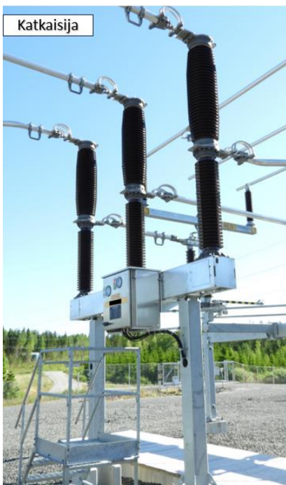
Kuvio 24. 110 kV katkaisija (Fingridin sähköasemien laitteet 2017)
