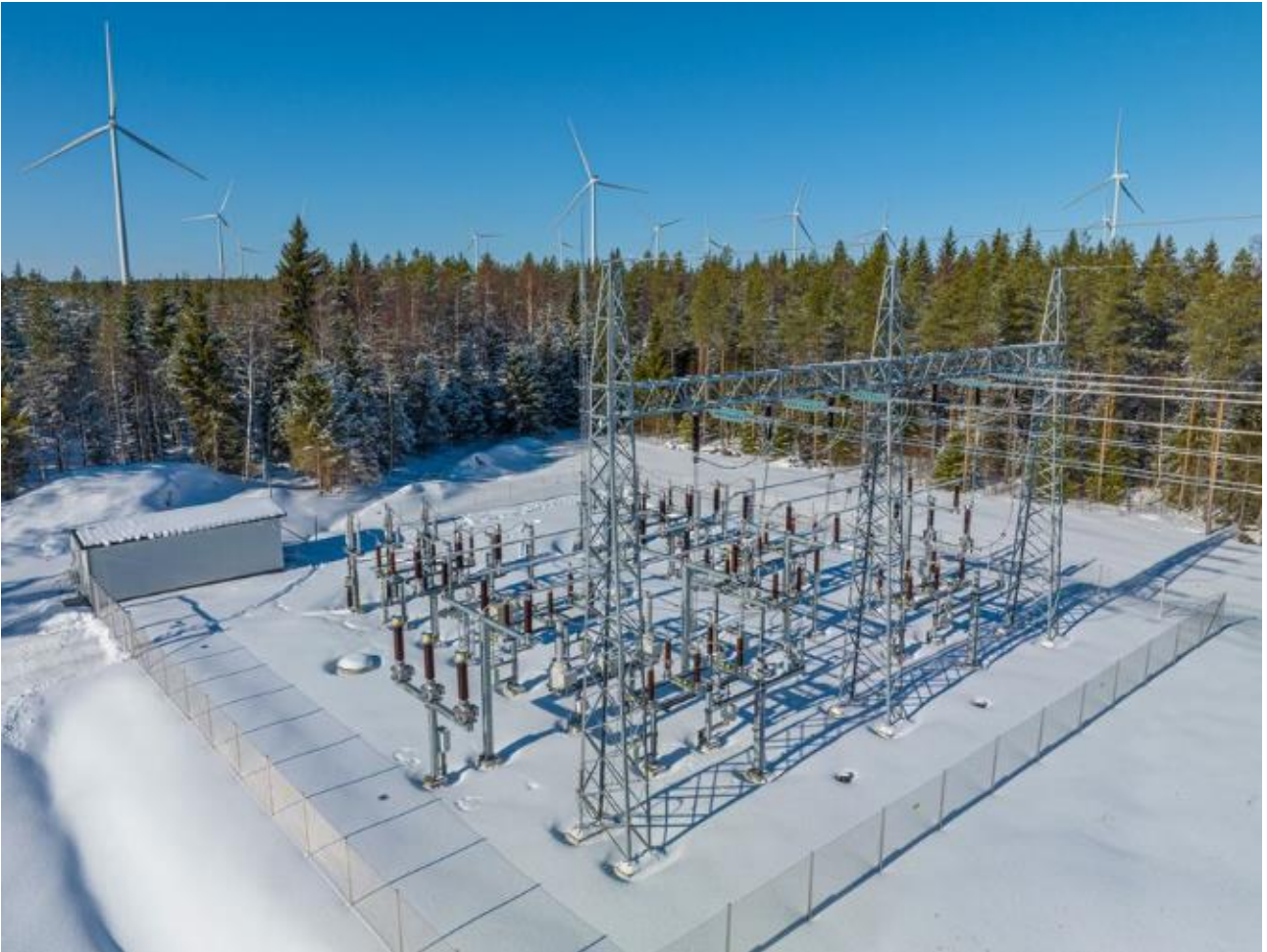
Kuvio 22. Tuulivoimapuiston sähköasema (Hitachi Energy 2023)
