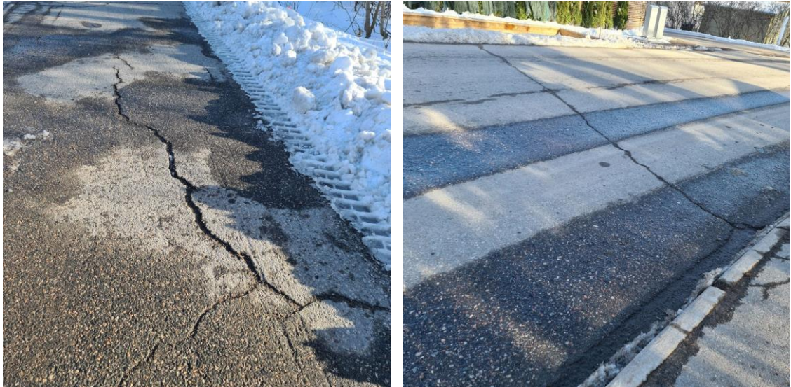
Kuvat 5 (vasen) ja 6 (oikea). Pituussuuntainen halkeama kevyen liikenteen väylällä ja poikittaissuuntainen halkeama, pakkaskutistumisen aiheuttama.
