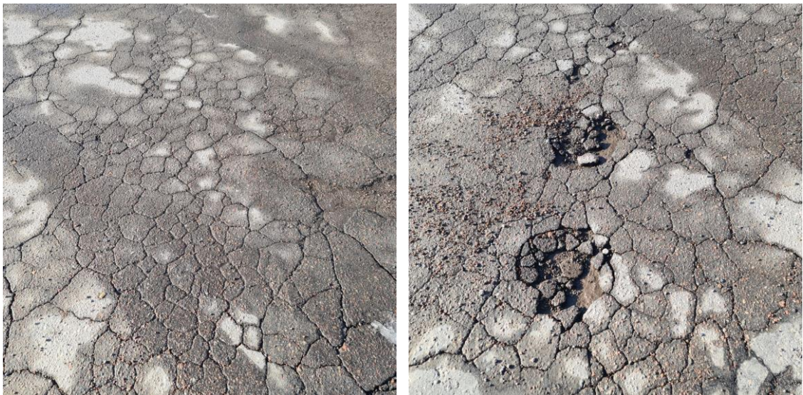
Kuvat 7 (vasen) ja 8 (oikea). Rakenteen pettämisestä aiheutunut verkkohalkeama ja verkkohalkeama, joka on alkanut purkautumaan rei'iksi.
