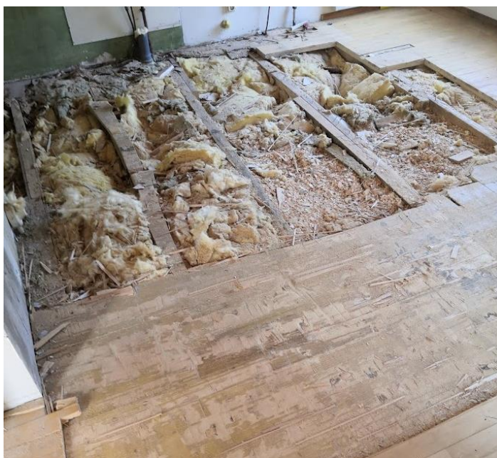
KUVA 21. Virheellinen alapohjan eristeasennus (Haaparanta 2024).
