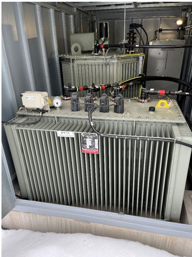
KUVA 17. Maadoitusmuuntaja Siilinjärven sähköasemalla
