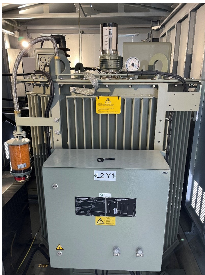
KUVA 12. Säädettä kompensointikuristin Siilinjärven sähköasemalla
